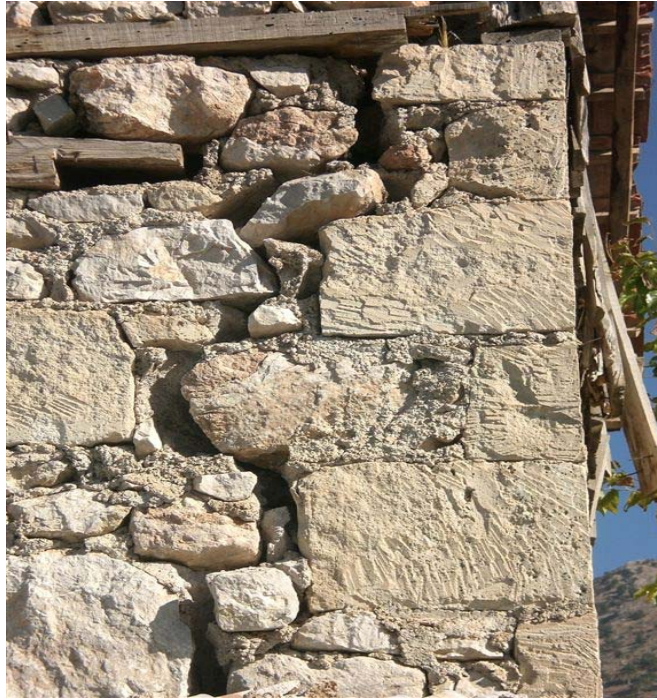
Şekil 4.4. Orta hasarlı bir yığma yapı duvarı
