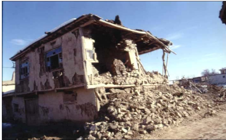
Şekil 4.6. Kısmen yıkılmış ağır hasarlı bir yığma yapı
