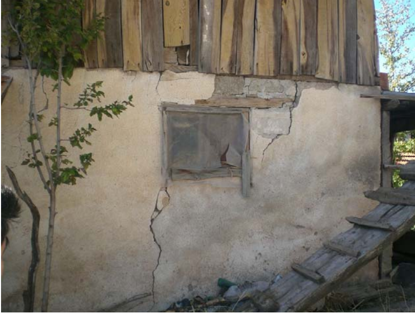
Şekil 4.2. Hafif hasarlı bir yığma yapı
