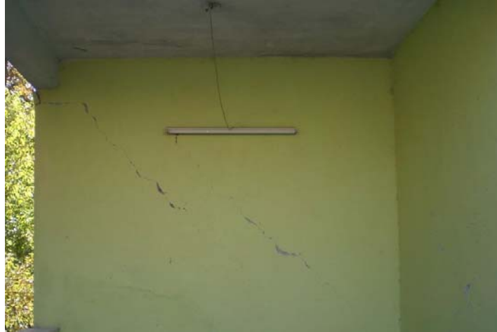
Şekil 4.7. Duvarlarda meydana gelen 45 derecelik çatlama
