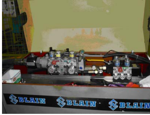
Şekil 3.5 : Hidrolik Güç Ünitesinin Fotoğrafı
