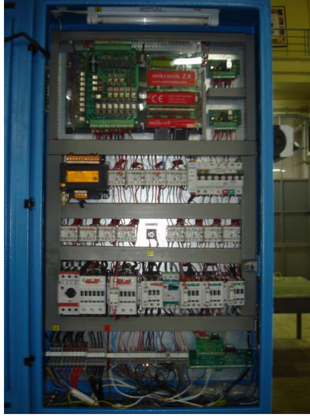
Şekil 3.18 : Elektrik Kumanda Panosu
