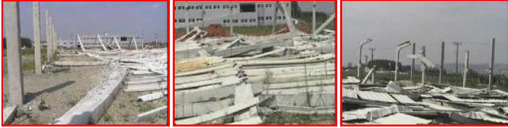
Şekil 2.6. Depremde hasar görmüş prefabrike binalar
