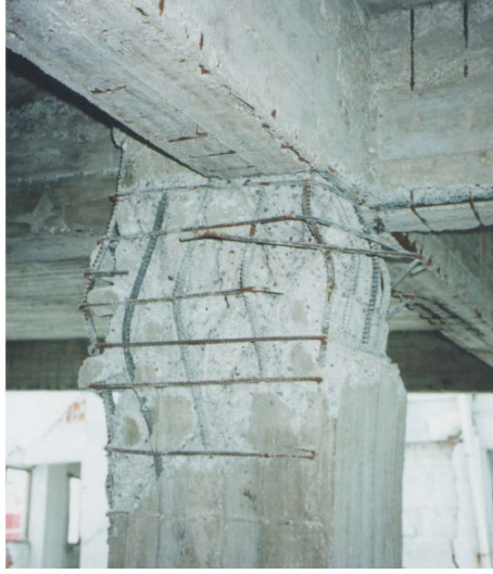
Şekil 1.1: 1999 Kocaeli depreminde hasar görmüş bir kolon (İlki 2006)
