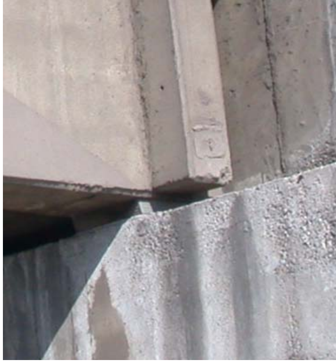
Şekil 2.4: Deforme Olmuş Elastomer Mesnet
