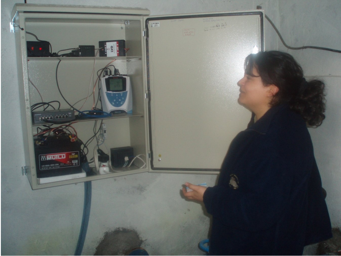
Şekil 14. Çelik sürekli kaynak suyu gözlem istasyonunda pano ve içerisindeki cihazların genel görünümü.
