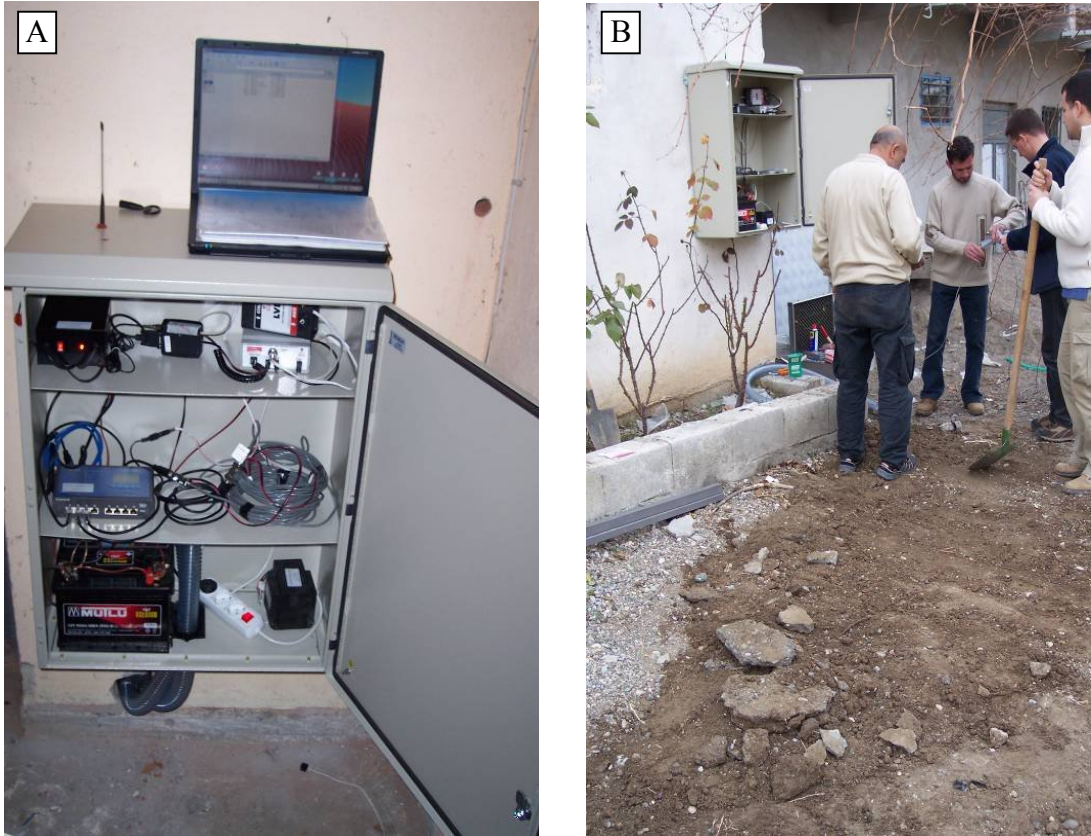
Şekil 12. Radon gözlem istasyonlarında bir görünüm (A: Çelik, B: Çiğli İstasyonu).
