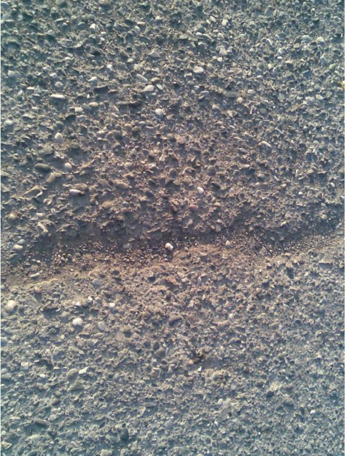
Ek-4 Termal Çatlaklar
