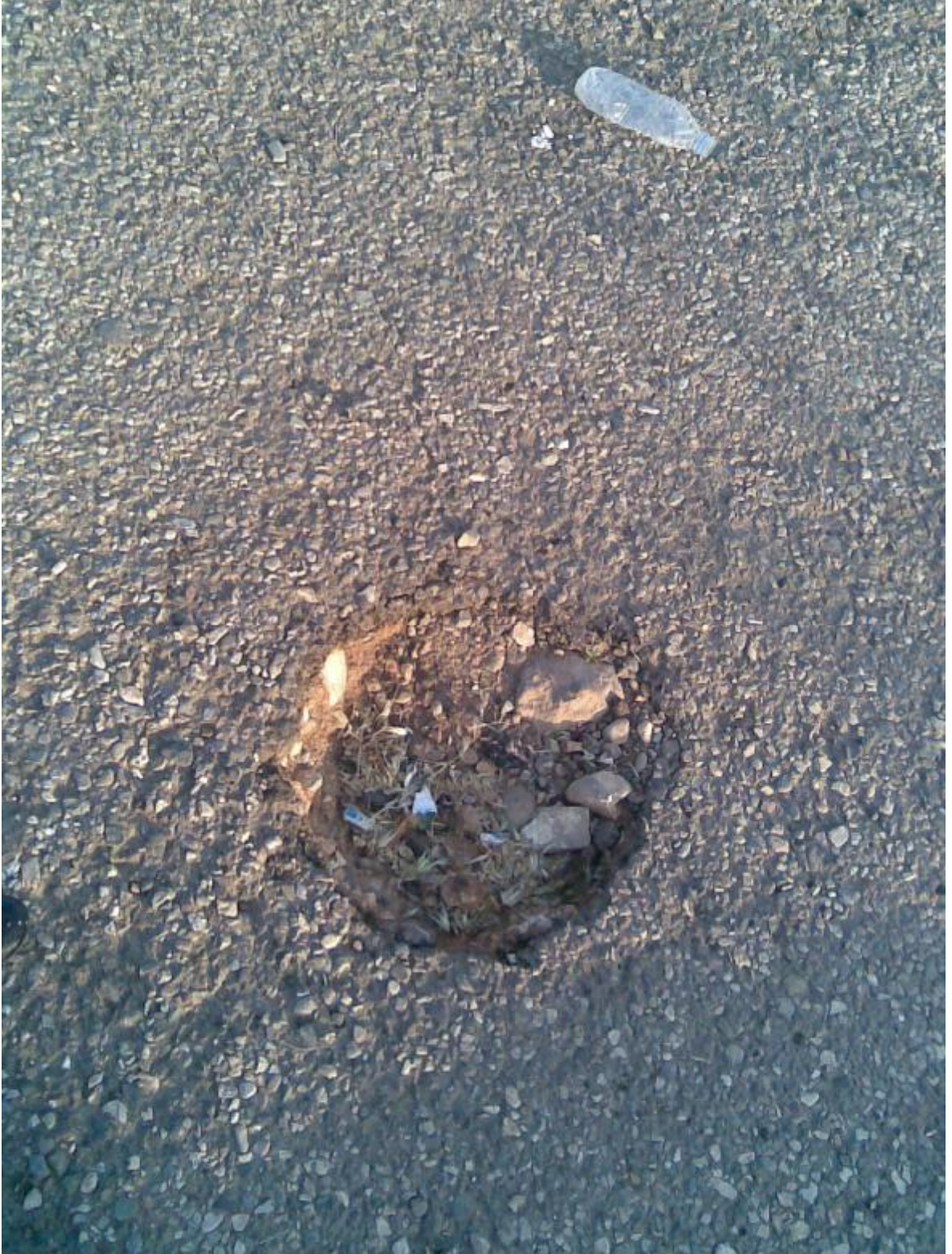
Ek-6 Folluk Tipi Çatlaklar
