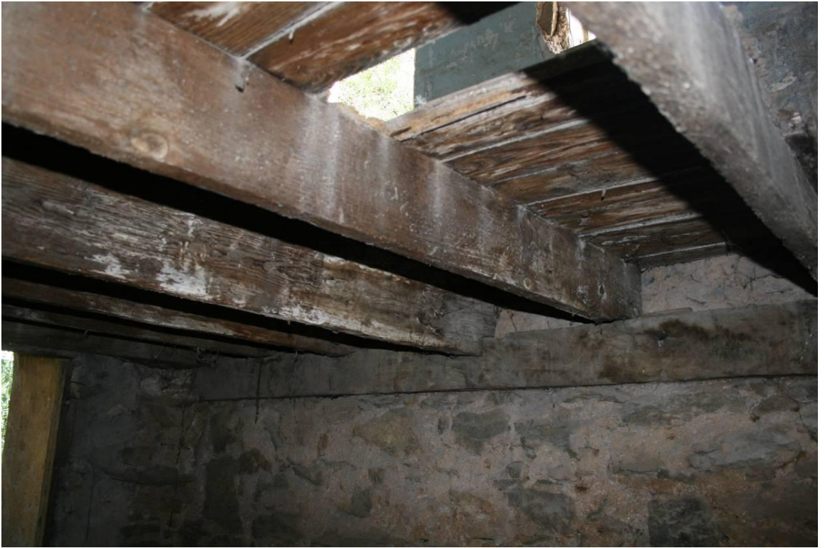
Fotoğraf 3.35 BB25 yapısında zemin katta kertiklenerek yerleştirilmiş kirişler ve kâgir subasman üzerinde kılıcına yerleşmiş taban detayı
