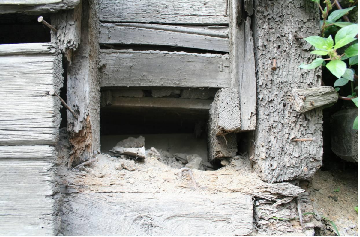
Fotoğraf 3.36 BB16 yapısında deforme olmuş taban kiriş birleşimi
