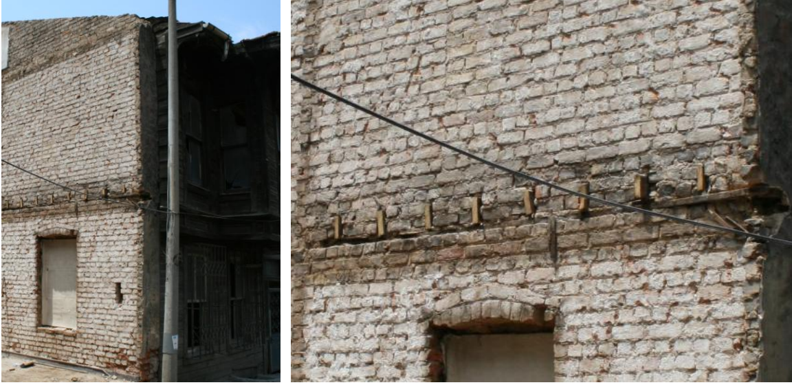
Fotoğraf 3.7 BB44 yapısının yıkılması sonucu açığa çıkan yangın duvarı üzerindeki taban ve kiriş izleri
