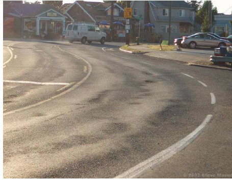
Şekil 2.22: Küçük yarıçaplı kurbada oluşan tekerlek izi ( www.asphaltwa.com )
