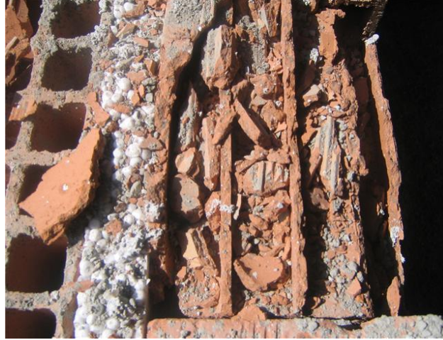
Şekil 3.2 Bay-Kes tuğla fabrikasının problemli ürünleri [32].
