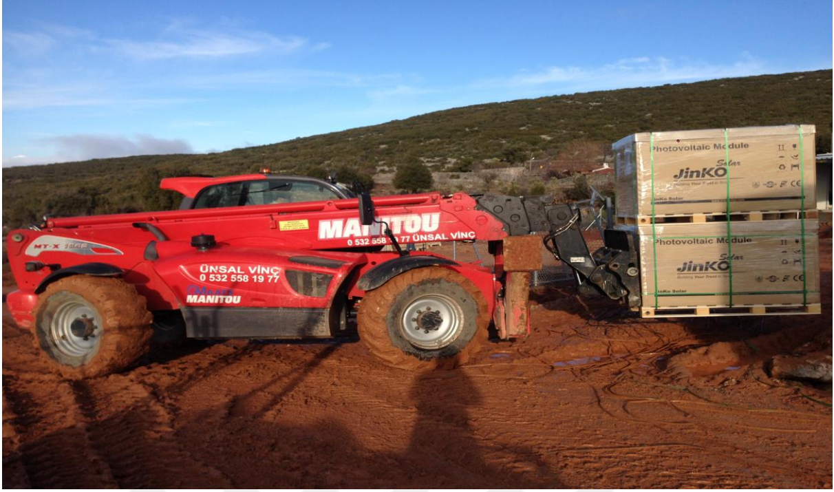
Şekil 4.9. C işyerine ait forklift ile yük taşınması
