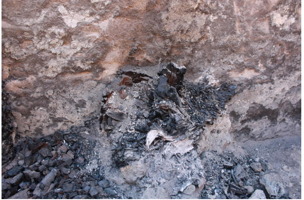
Resim 27. Depo Odalarının Yanmış Üst Örtü Yıkıntısı
