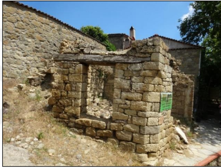
Şekil 3. 84 Harap durumdaki yapılar, 563 Ada 9-10 parsel [E. Alyakut, 2017]
