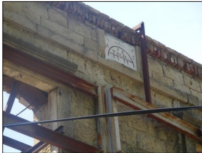
Şekil 5. 2 552 Ada 6 Parsel, acil koruma önlemi alınmış yapı [E. Alyakut, 2017]
