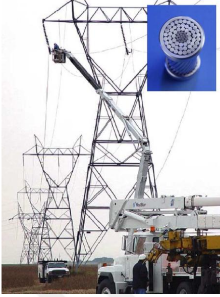
Resim 3.1. İletken kabloların kurulu olduğu güç taşınımı kuleleri ve Al/Al 2 O 3 MMK iletken kablosu [28]
