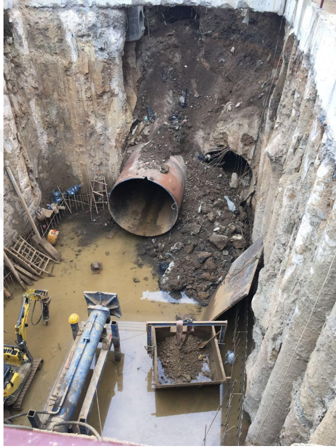
Şekil 3.7 Boru İtme Şaftı
