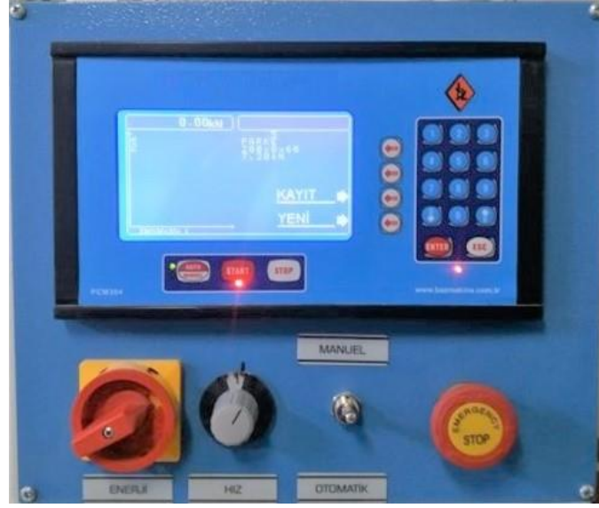
Şekil 4.18. YNY kontrol paneli görünüşü
