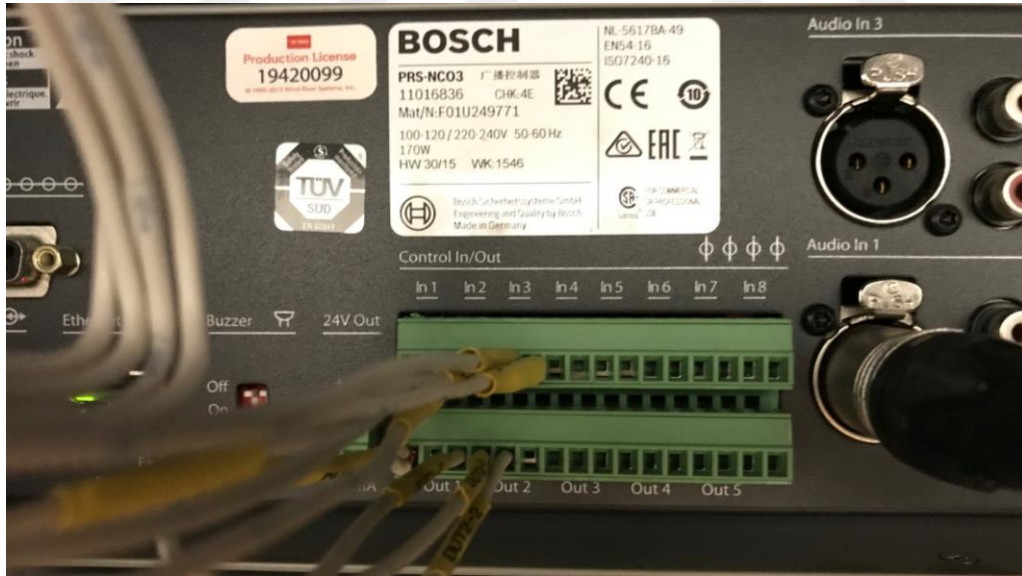
Şekil 5.13 Anons kuru kontak bağlantıları
