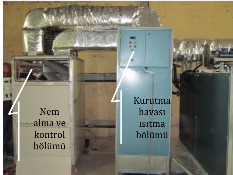
Şekil 3.6. Kurutma havası ısıtma - nem alma düzeneği ve kontrol bölümü
