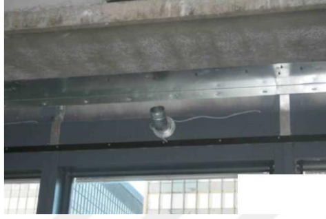
Şekil 2.38. Binanın havalandırma sistemini cephe modülüne bağlayan havalandırma hücresinin görünümü (Loncour vd., 2004)
