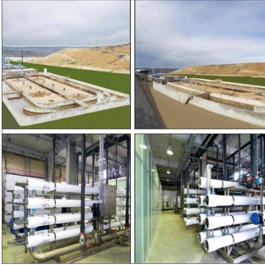
Foto 21: Şile Çöp Sızıntı Arıtma Tesisinden Görüntüler
