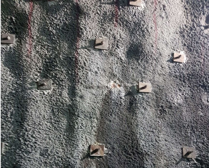
Şekil 4.11 : Kaya bulonu ve plakası (Cebeci Tüneli).
