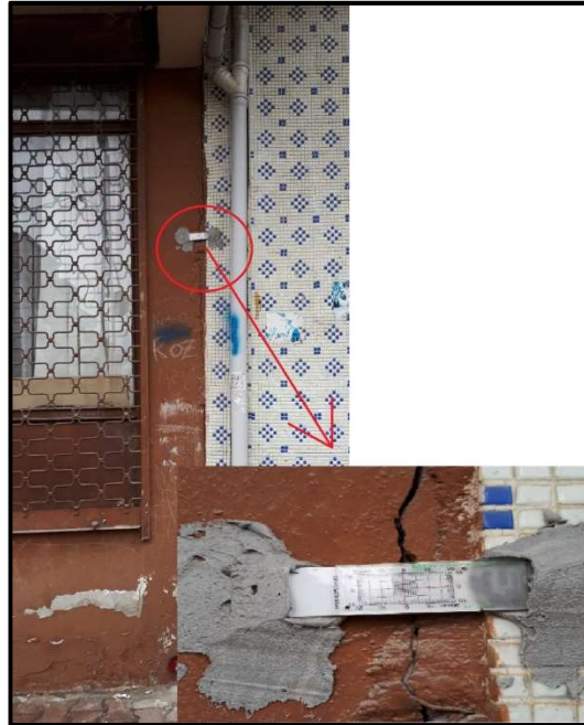
Şekil 5.3 : Çatlak ölçer (Cebeci).
