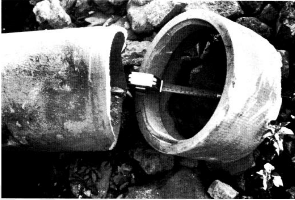
Şekil 3.4 : 1985 Michoacan Meksika depreminde asbest boruda bağlantı noktasında meydana gelen kırılma (Ayala ve O'Rourke, 1989).
