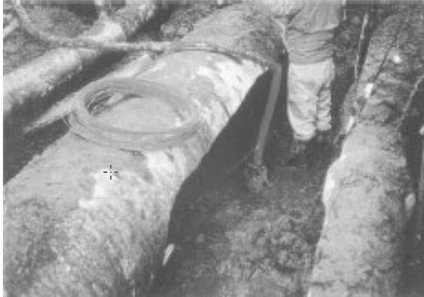
Şekil 3.2 : Düktil Font ve Font su boru hatlarındaki hasarlar (Editorial Committee for the Report on the Hanshin – Awaji Earthquake Disaster, 1997; Matsushita, 1995).
