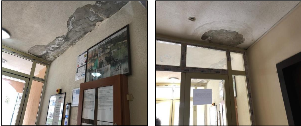
Şekil 3.58 : Kalıcı konutlarda oluşan hasarlar
