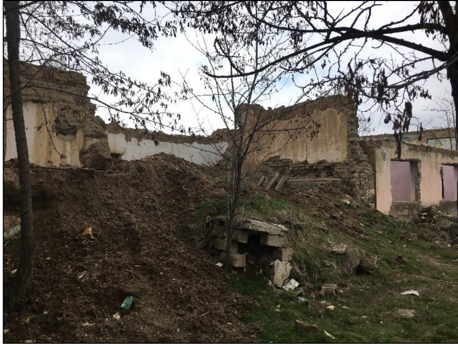
Şekil 3.23 : Deprem sonrası yıkılan konut yapıları.
