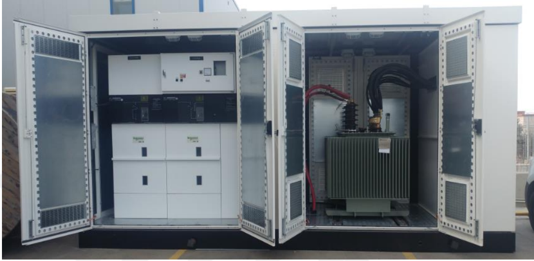
Şekil 4.9: OG hücre ve trafo odasının metal köşk içerisindeki görünüşleri.
