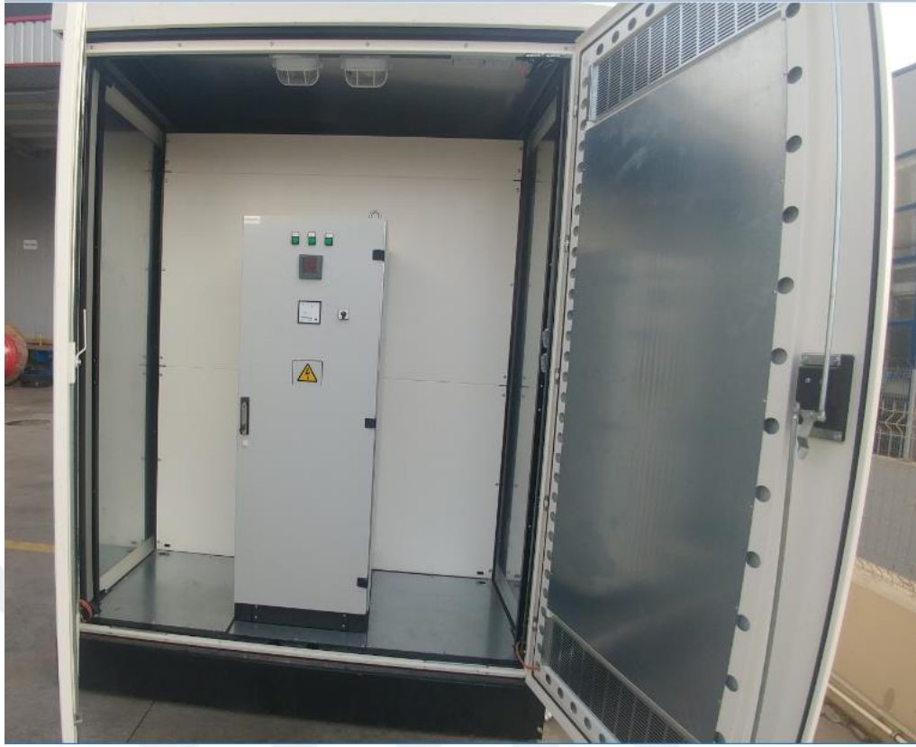
Şekil 4.7: AG odasının köşk içerisinde görünüşü.
