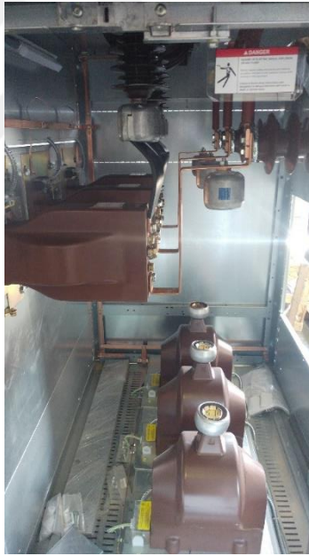
Şekil 3.8: Akım ve gerilim trafolarının modüler hücre içindeki görünüşü.
