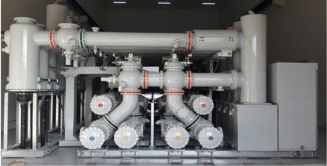
Şekil 3.2: Gaz izoleli trafo merkezleri.
