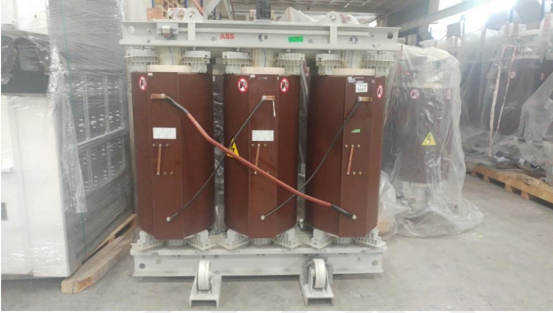
Şekil 3.10: Kuru tip dağıtım transformatörün görüntüsü.
