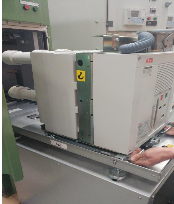
Şekil 3.7: Metal clad hücre içinden çıkarılmış vakum kesici görünüşü.
