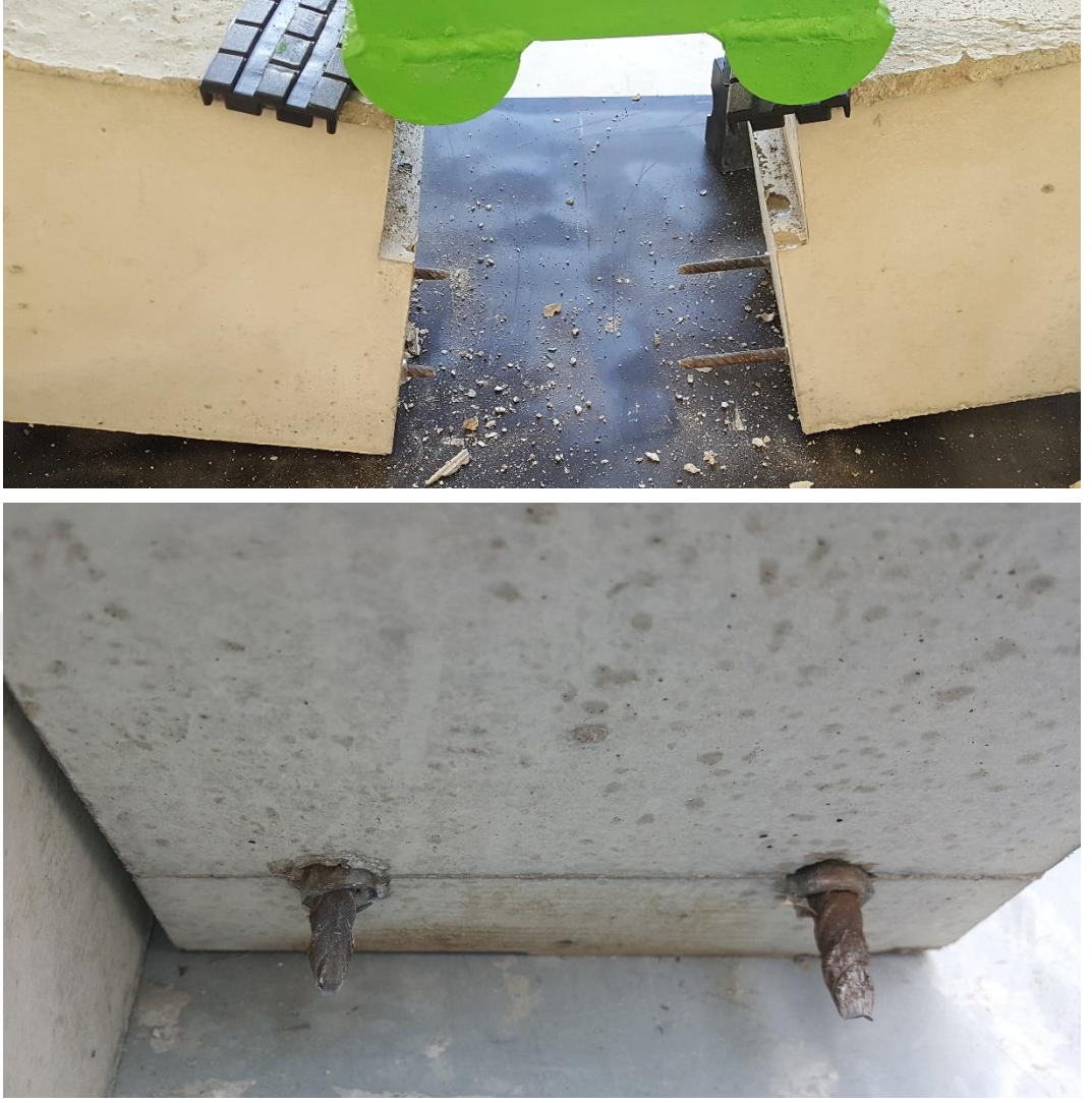
Şekil A.14. Donatı kopması ile sonuçlanmış kiriş numunesi
