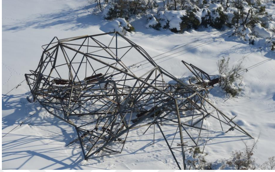
Şekil 1.12: Yıkılmış olan 154 kV enerji iletim hattı
