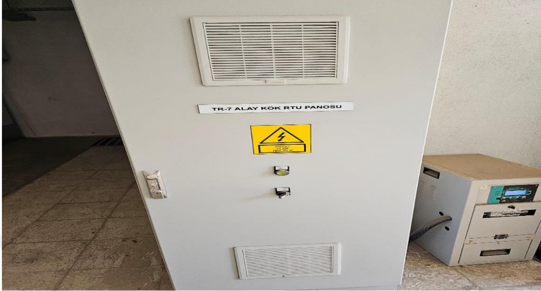
Şekil 2.4. RTU pano dış görünümü
