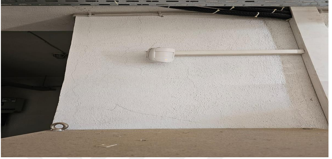
Şekil 2.20. DM kapı girişinde bulunan pır dedektörü
