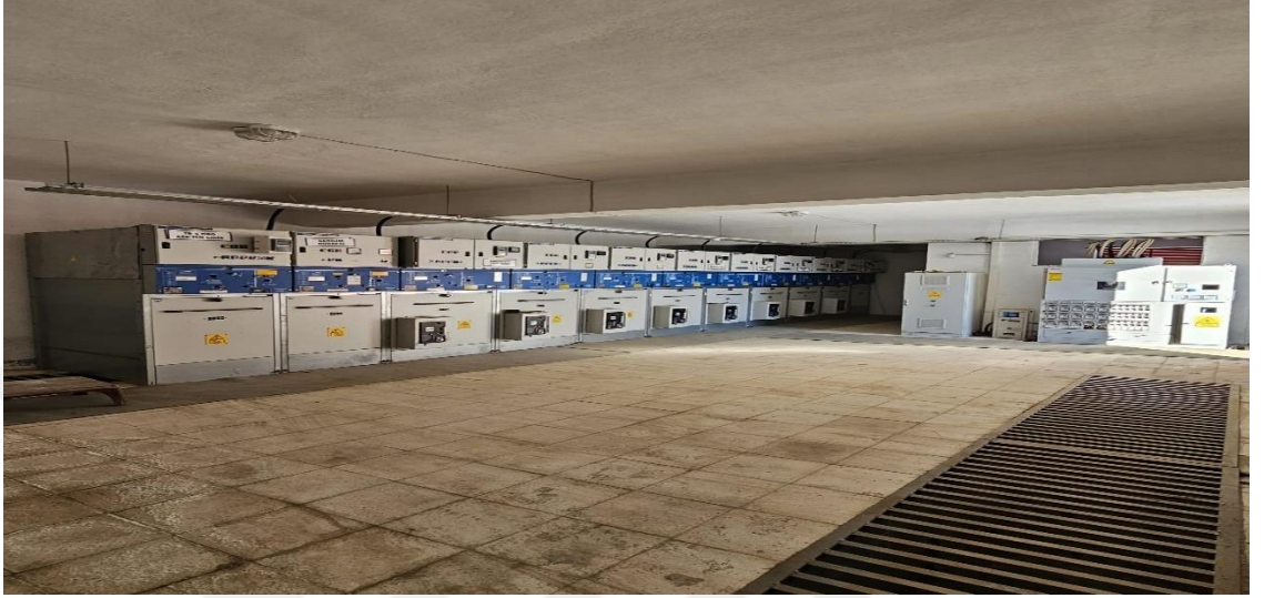
Şekil 3.4. VEDAŞ Bitlis İlinden örnek Dağıtım merkezi
