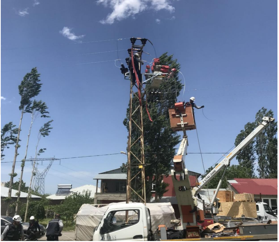
Şekil 3.9. Van Gevaş ilçesinde montajı yapılan otomatik yük ayırıcısı(Sectionalizer)
