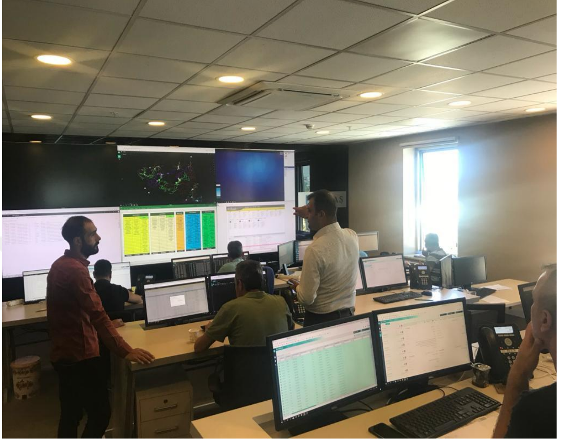
Şekil 2.1. VEDAŞ SCADA kontrol ve kumanda merkezi
