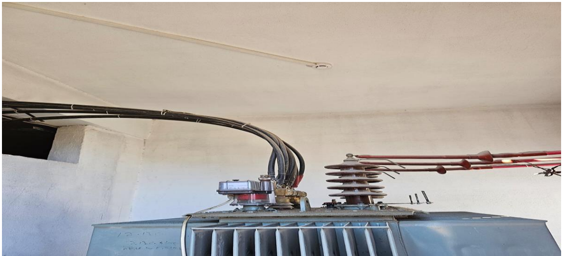
Şekil 2.19. Transformatör tavan kısmında bulunan yangın dedektörü
