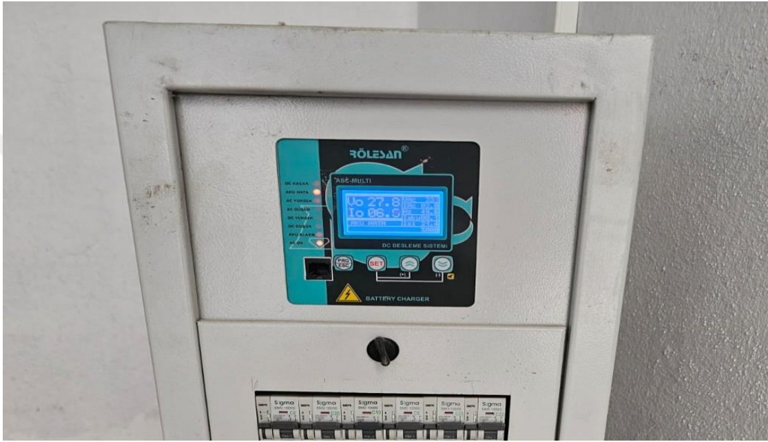
Şekil 2.17. DM içerisinde bulunan Redresör
