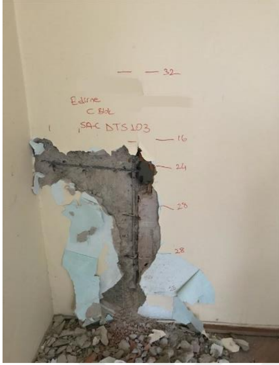
Şekil 4. 5 Bina olumsuzluk fotoğrafı-2
