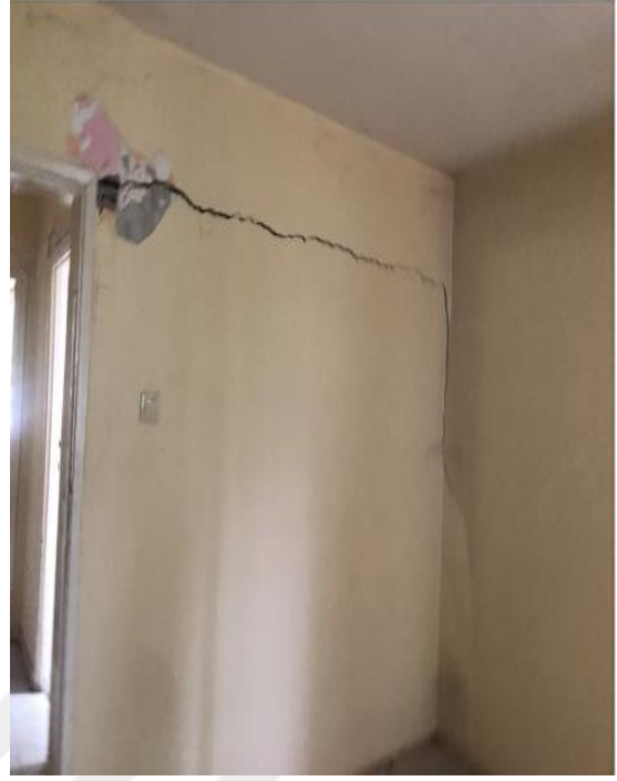
Şekil 4. 6 Bina olumsuzluk fotoğrafı-3
