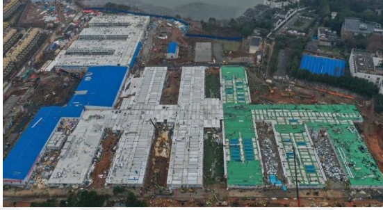
Şekil 2.7 Çin’de inşa edilen Huoshenshan Hastanesi (New China TV, 2020)
