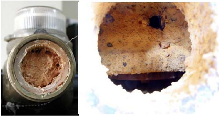
Şekil 2.23. Sayaç içerisindeki kireç birikintisi (Estevan 2005)
