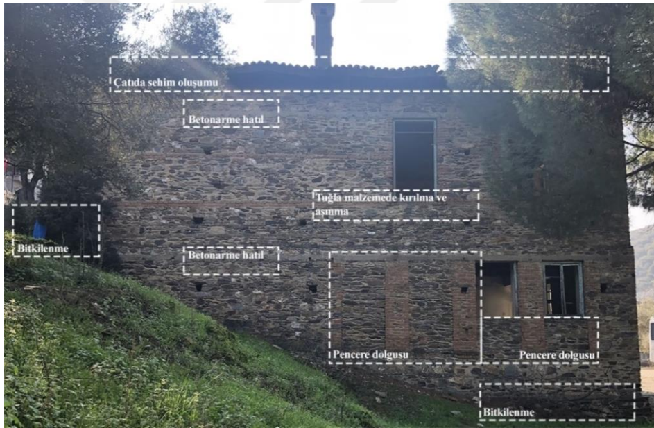
Şekil 5.59 Kuzey cephesi bozulmaları (İdeli Kişisel Arşivi, 2024)
