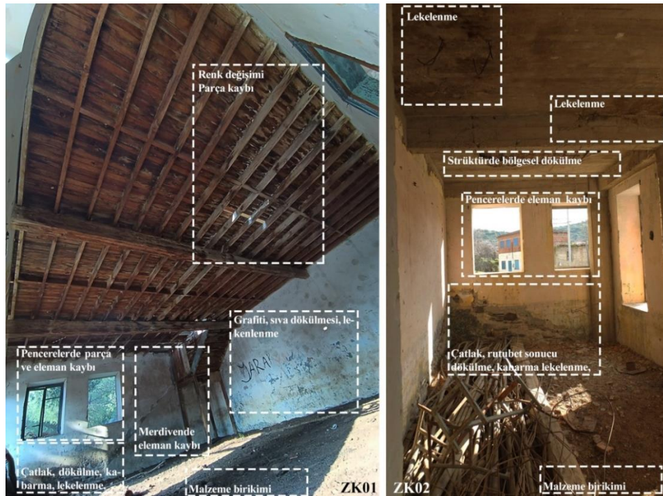
Şekil 5.55 Zemin kat ZK01 ve ZK02 bozulmaları (İdeli Kişisel Arşivi, 2024)
