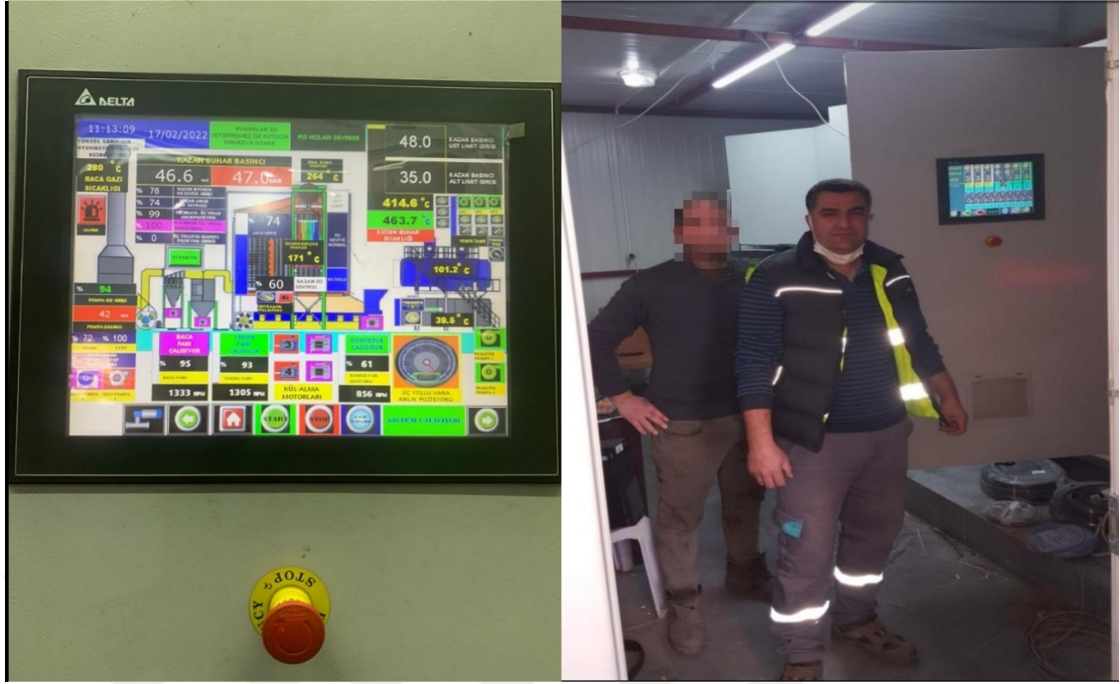
Şekil 2.13. Elektrik ve Otomasyon Panoları
