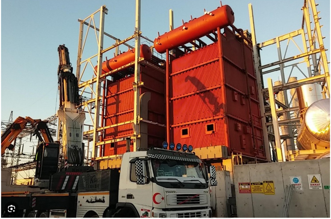
Şekil 2.14. Su Borulu Biyokütle Kazan Tesisi
