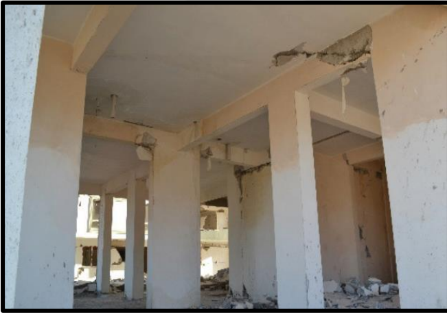
Resim 1.5. Kısa kirişte oluşan kesme hasarı-1 [4]
