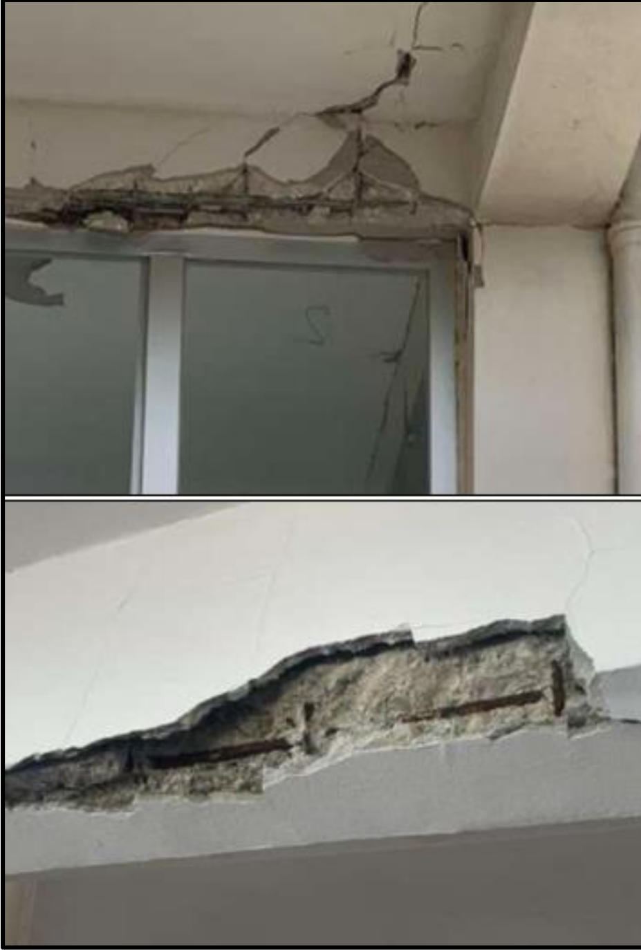
Resim 1.1. Kahramanmaraş depremleri sonucu kirişlerde oluşan kesme hasarları-1 [2]
