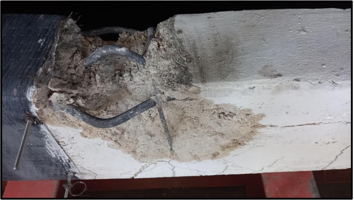
Resim 6.9. Kirişte bulunan boyuna donatının burkulması ve betonun ezilmesi
