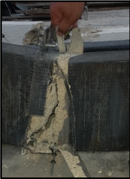
Resim 6.13. Kirişte oluşan çatlak
