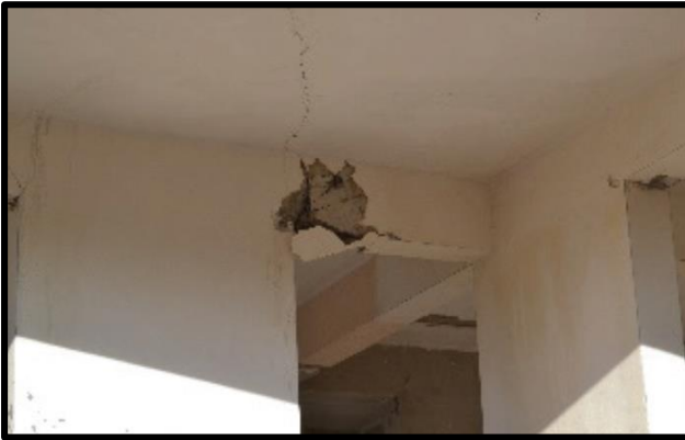
Resim 1.6. Kısa kirişte oluşan kesme hasarı-2 [4]
