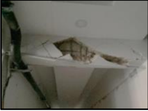
Resim 1.4. Kahramanmaraş depremleri sonucu kısa kirişte oluşan kesme hasarı [3]
