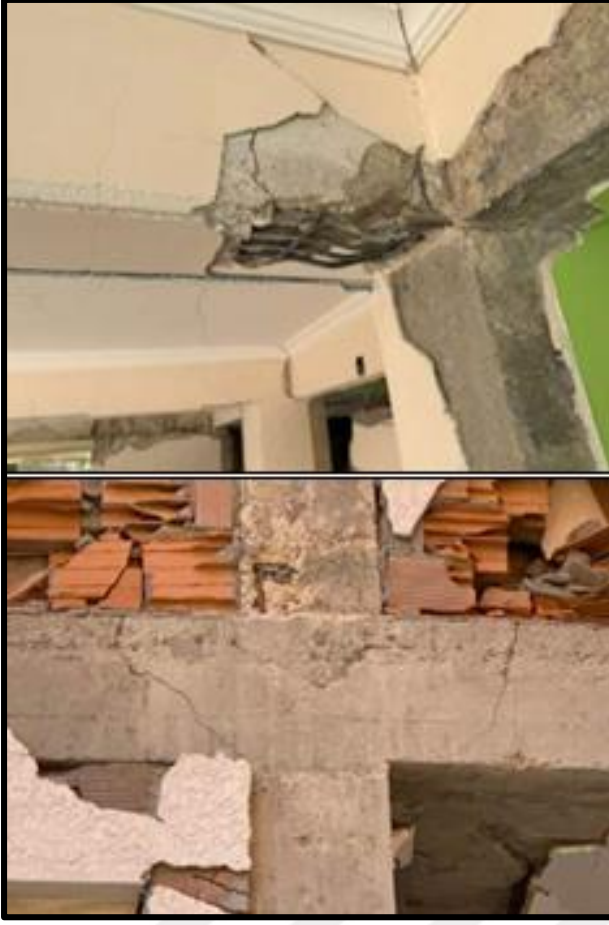
Resim 1.2. Kahramanmaraş depremleri sonucu kirişlerde oluşan kesme hasarları-2 [2]
