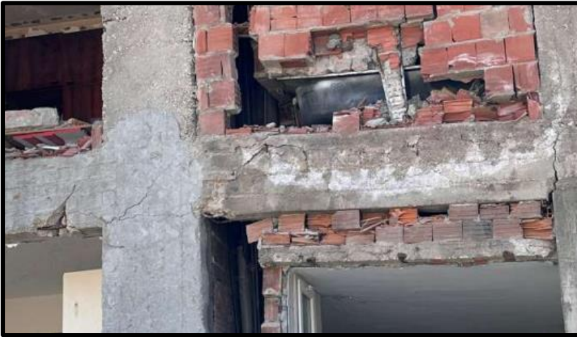
Resim 1.3. Kahramanmaraş depremleri sonucu kirişlerde oluşan kesme hasarları-3 [2]
