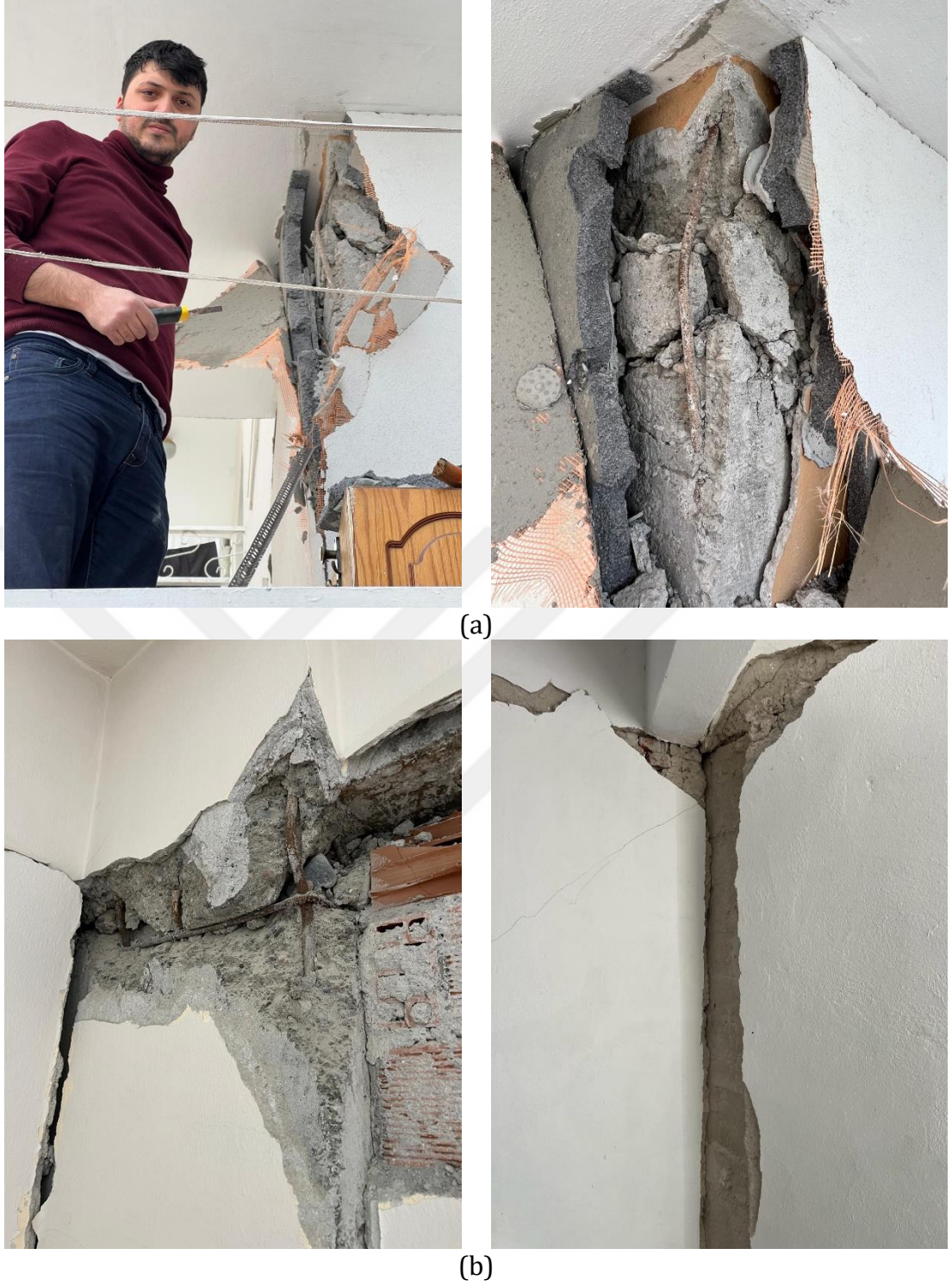
Şekil 4.25. Malatya'daki konutlarda ortaya çıkan kolon-kiriş birleşim bölgesi hasarı
