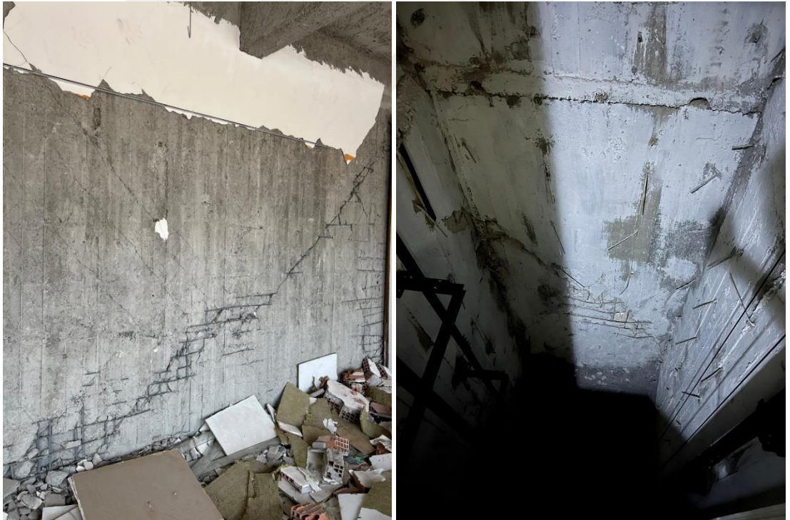
Şekil 4.29. Kesme çatlağı ve segregasyon görülen perde duvar
