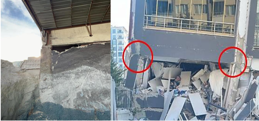
Şekil 4.54. Zayıf kolon güçlü kiriş hasarı nedeniyle ağır hasar alan yapılar
