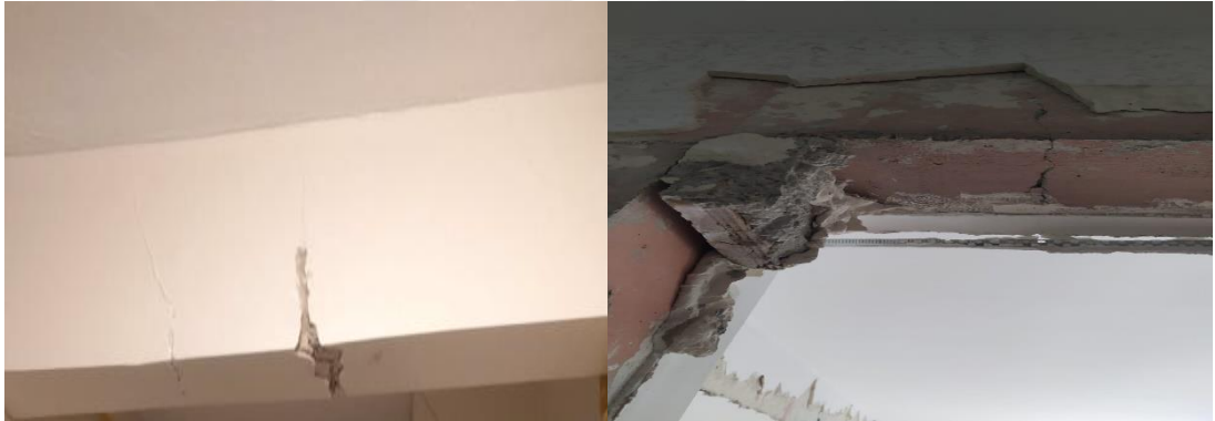
Şekil 4.21. Kirişinde eğilme çatlağı oluşan yapı
