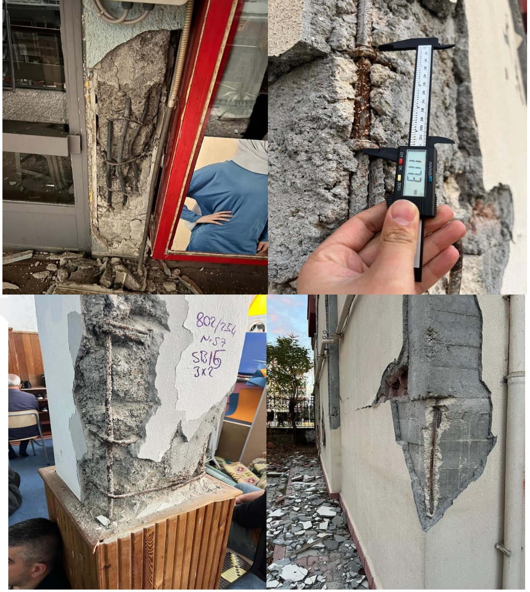
Şekil 4.65. Düz demir ve yatay donatıların uygun yerleştirilmemesine bağlı olarak hasar gören bir yapı
