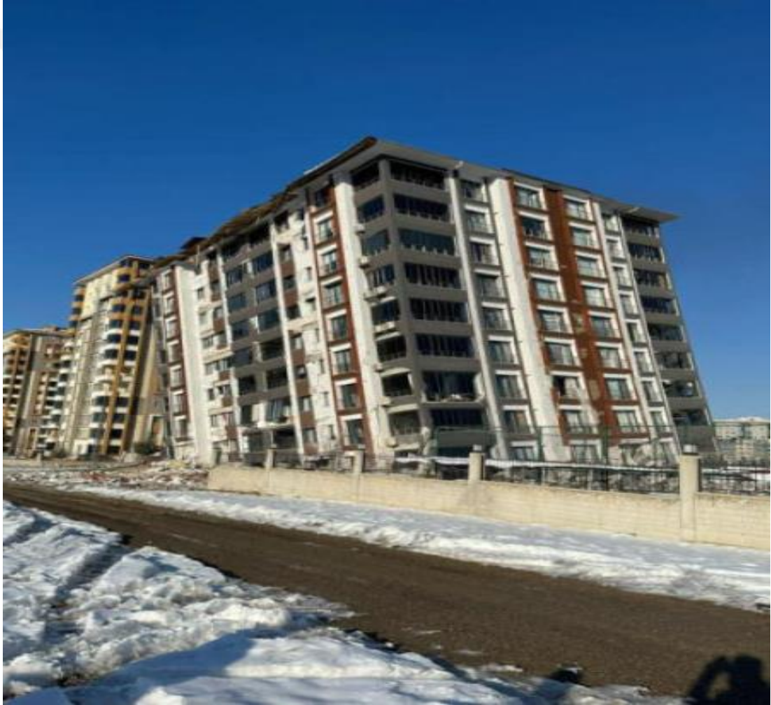
Şekil 4.13. Burulma düzensizliği nedeniyle ağır hasar alan bir binaya ilişkin görünüm
