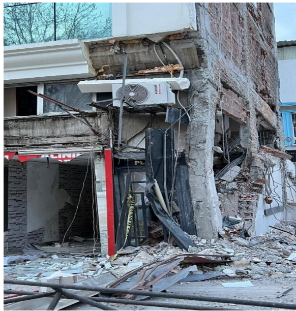
Şekil 4.57. Malatya’da zayıf kat hasarı alan bir yapı
