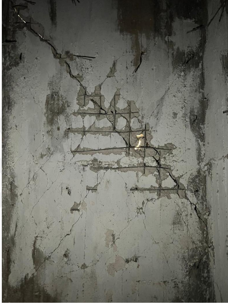
Şekil 4.31. Asansör perdesinde gözlenen burulma hasarı
