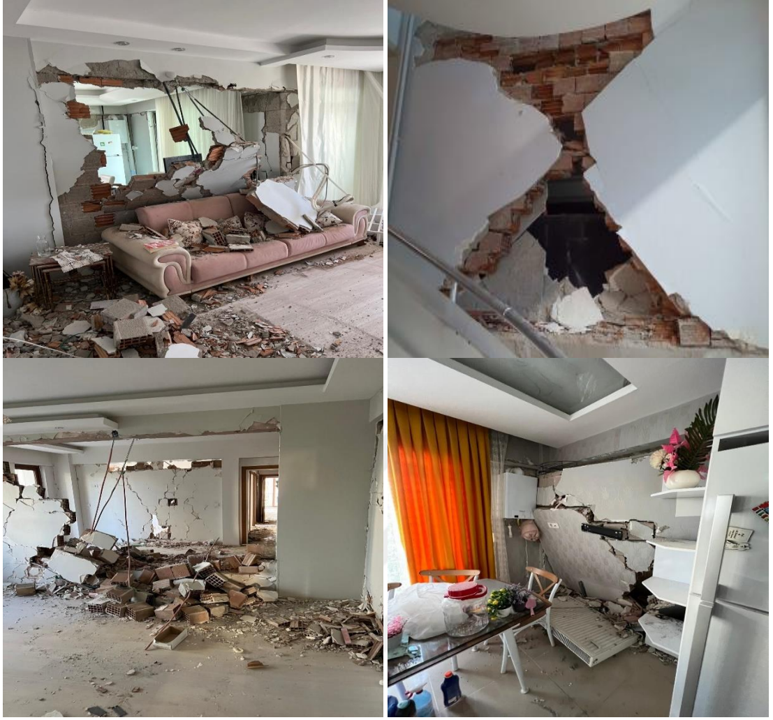
Şekil 4.45. Malatya’da deprem nedeniyle duvarları kırılan yapılar
