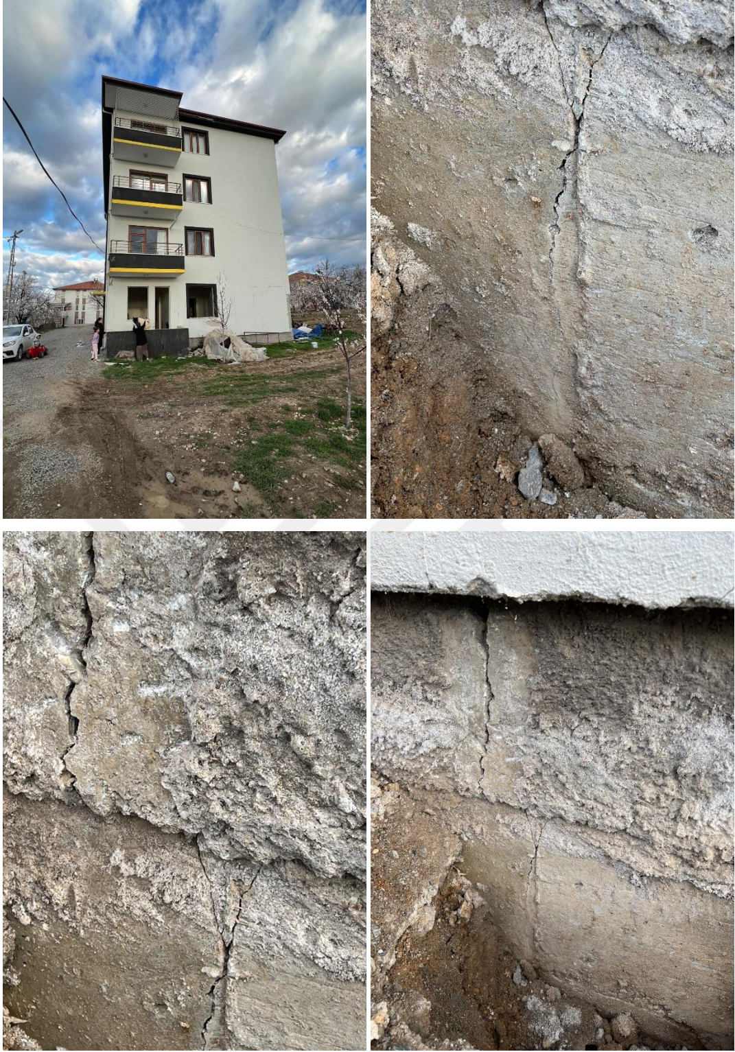
Şekil 4.35. Zemin sıvılaşması ve temel derinliği yetersizliğine bağlı olarak ortaya çıkan subasman hasarı
