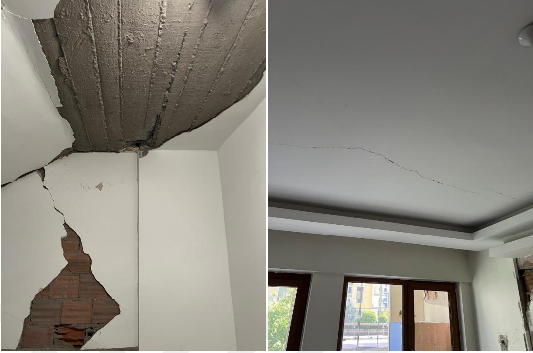
Şekil 4.4. Döşeme hasarı oluşan yapıya ilişkin görüntü
