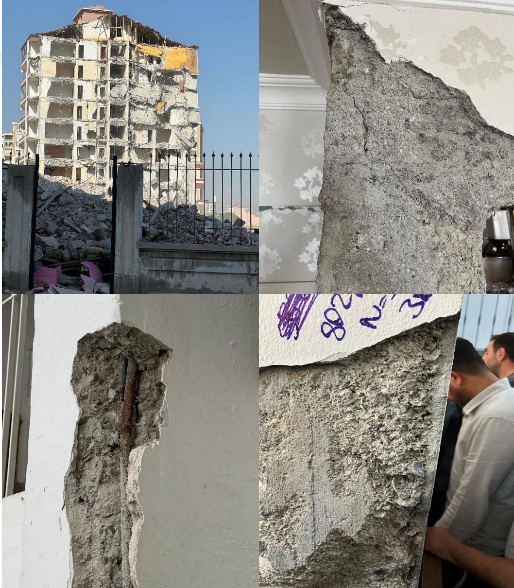
Şekil 4.62. Düz demir ve düşük kalite beton kullanımına bağlı olarak ağır hasar alan yapı
