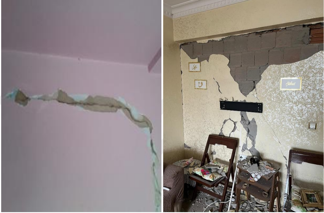
Şekil 4.41. Malatya'daki bir yapıda ortaya çıkan kolon-kiriş-duvar birleşiminde oluşan çatlaklar
