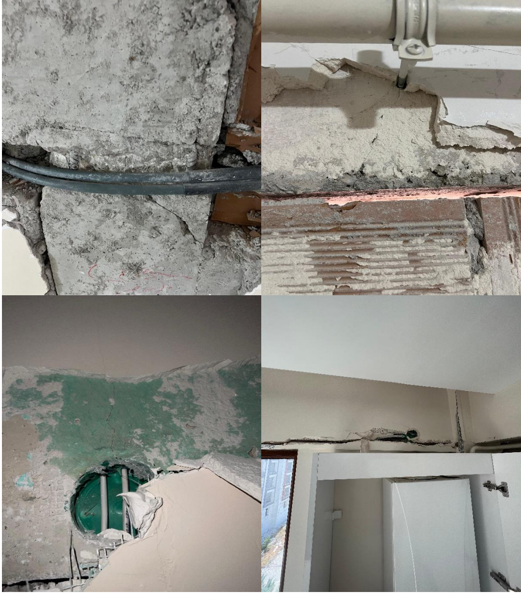
Şekil 4.67. Taşıyıcı elemanlar üzerinden tesisat elemanlarının geçirilmesine bağlı olarak ortaya çıkan yapı hasarları
