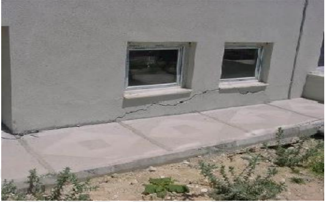
Şekil 4.47. Temel oturmalarından kaynaklanan duvar hasarları
