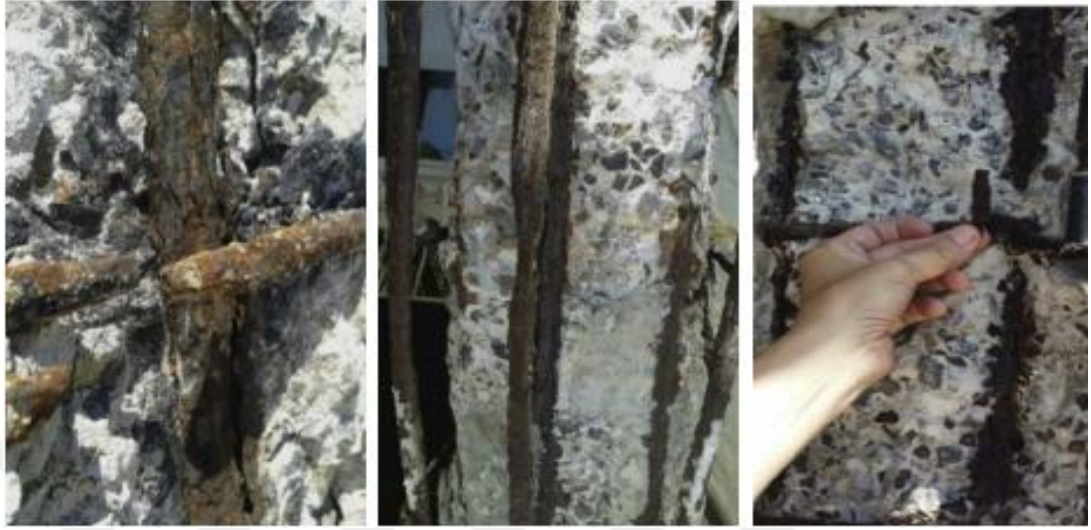
Şekil 4.68. Korozyona uğramış donatı (Taşdemir vd., 2000)
