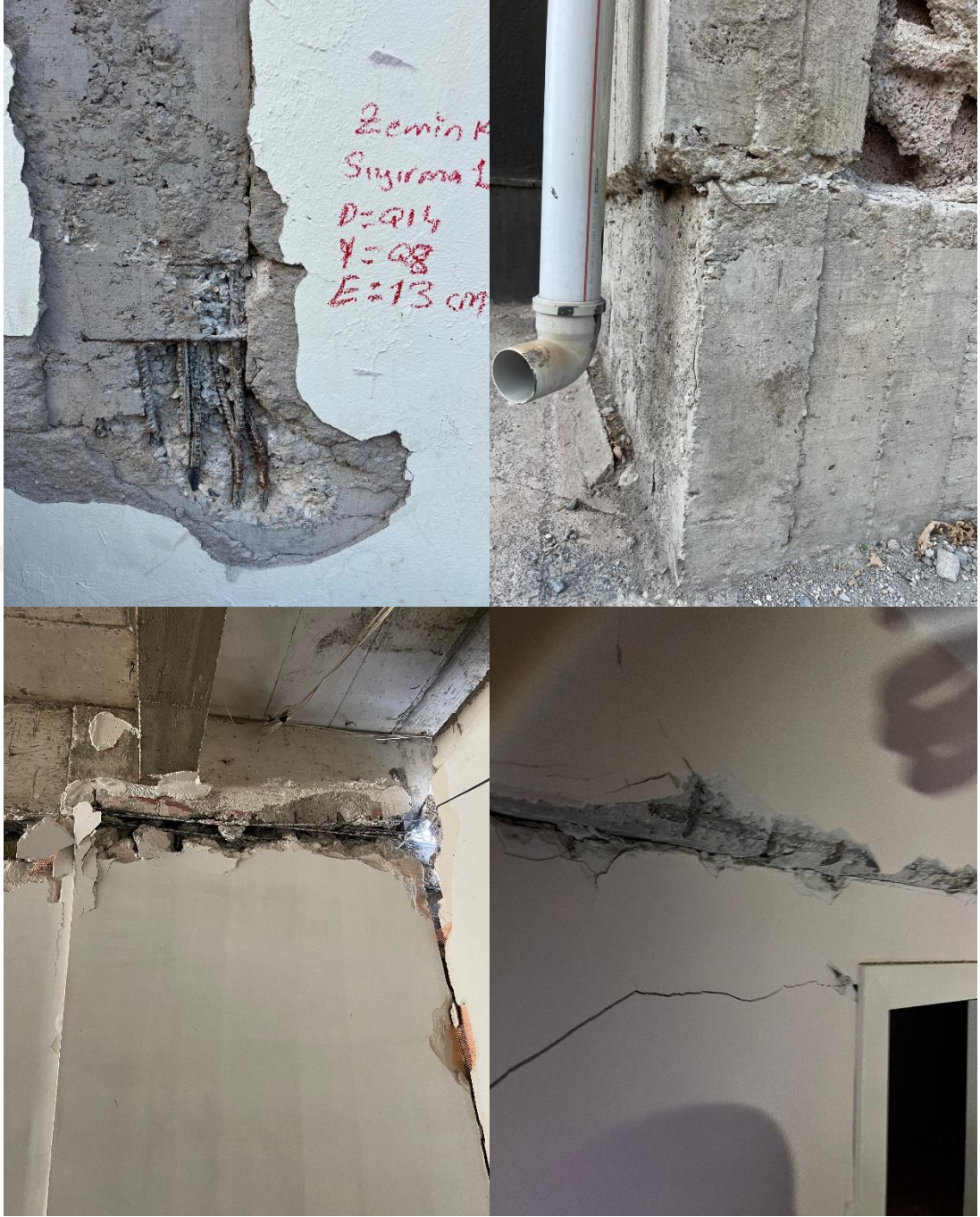
Şekil 4.69. Statik hesaplama ve işçilik kaynaklı hasar
