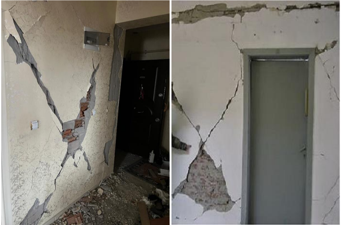
Şekil 4.43. Duvarları orta düzeyde hasar alan bir yapı
