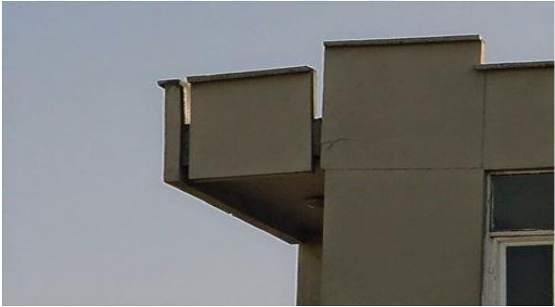
Şekil 4.51. Aşırı sehim kaynaklı duvar hasarları (URL-1)
