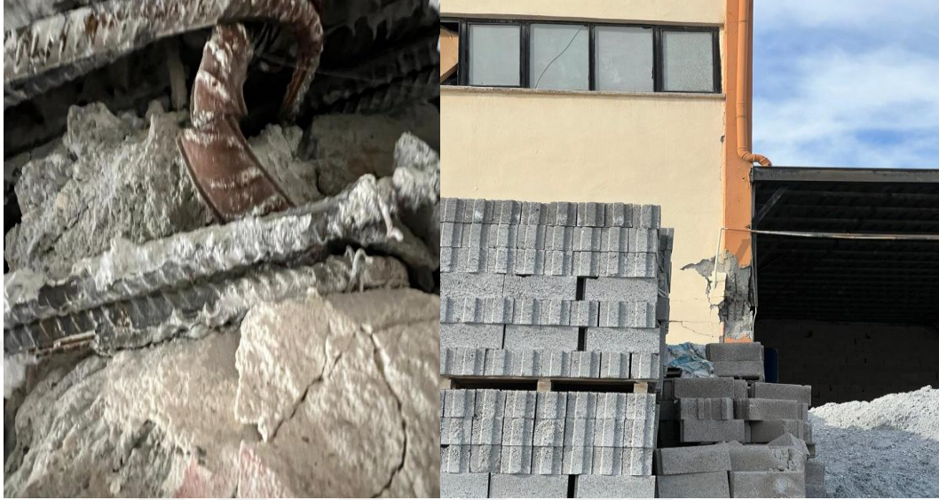
řekil 4.55. Malatya'da burulma hasarı grlen bazı yapılar
