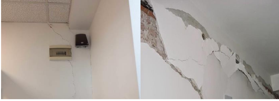
Şekil 4.39. Tesisat kaynaklı duvar çatlakları
