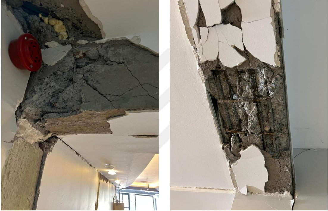
Şekil 4.23. Kirişlerde meydana gelen burulma çatlağı
