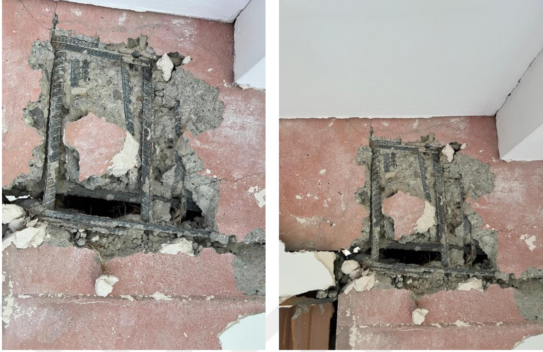
Şekil 4.5. Malatya’da hasar tespiti yapılan bir yapının kolonunda gözlenen mafsallaşma hasarı
