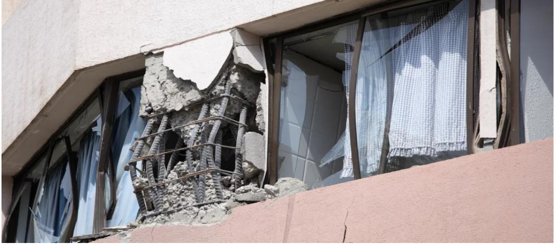
Şekil 4.19. Kısa kolon hasarı
