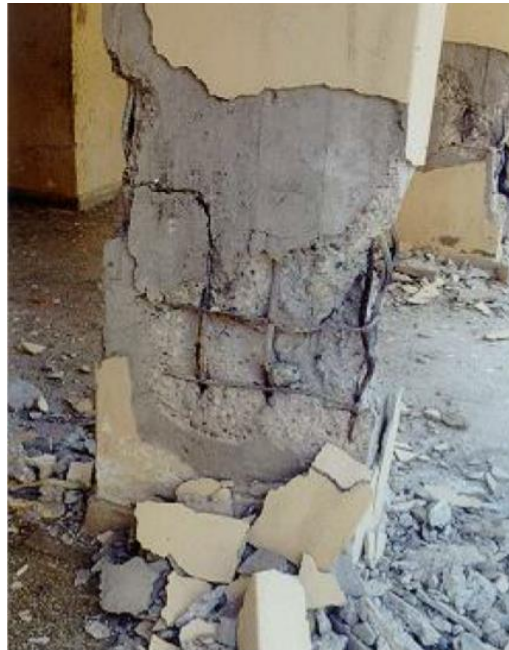
Şekil 4.8. Kesme ve eğilme hasarı görülen bir kolon (Çırak, 2011)
