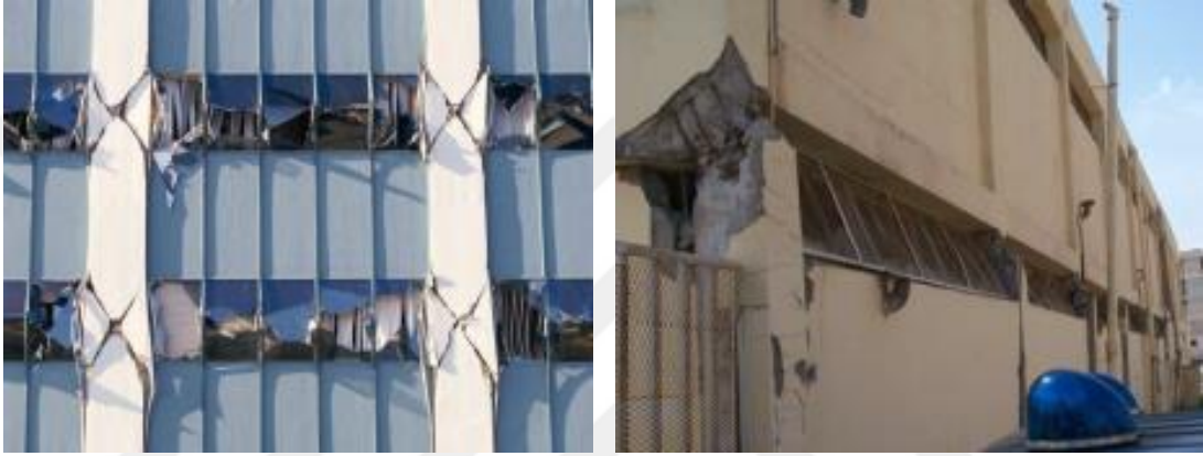
Şekil 4.61. Kısa kolon hasarı alan yapılar
