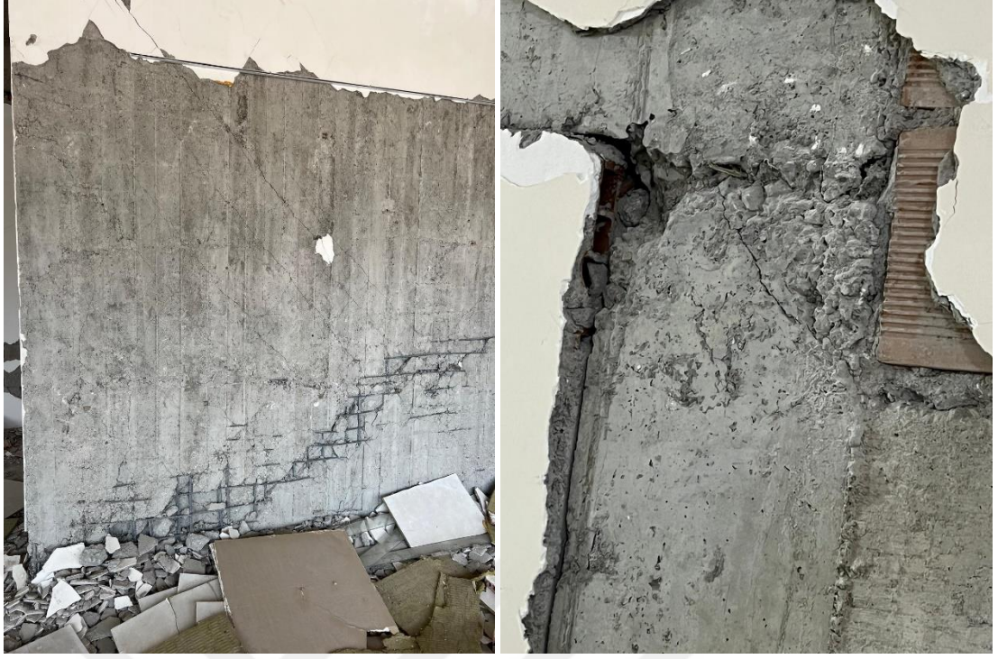
Şekil 4.66. Segregasyon nedeniyle hasar almış perde ve kolon
