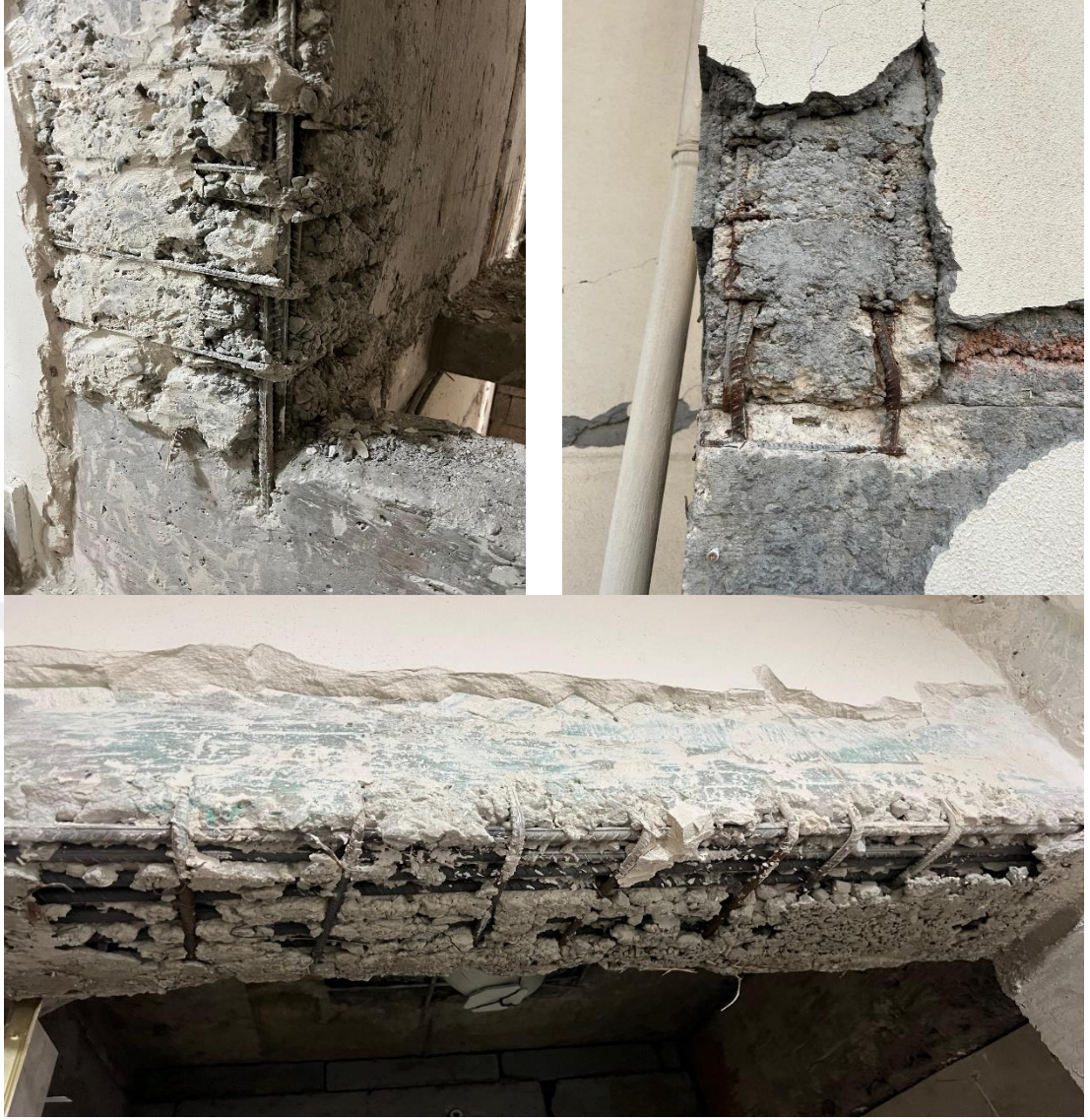
Şekil 4.1. Betonda ayrışma (segregasyon)
