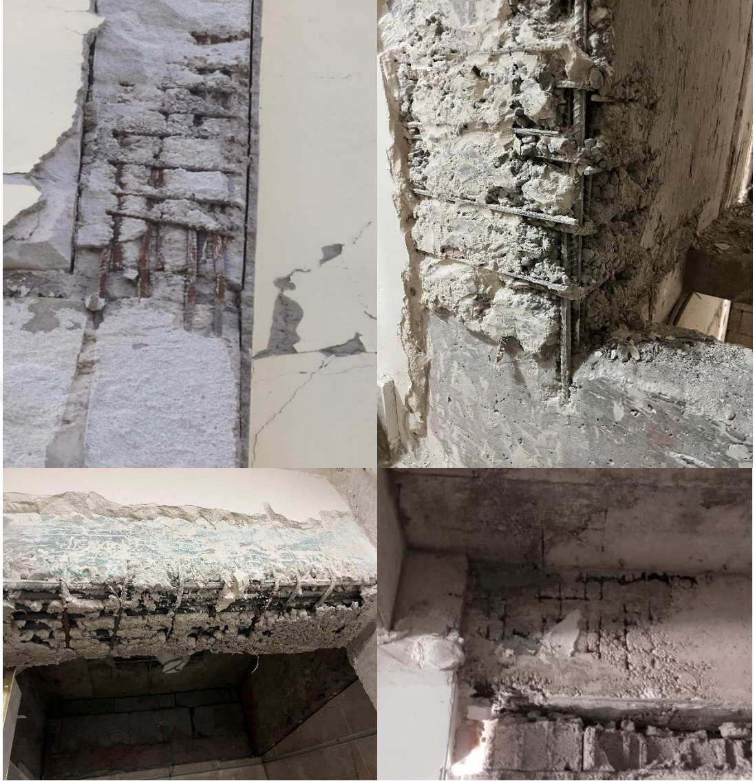
Şekil 4.63. Betonarme elemanlarda segregasyon sonucu oluşan mikroyapısal bozulmalar ve makro ölçekli hasarlar
