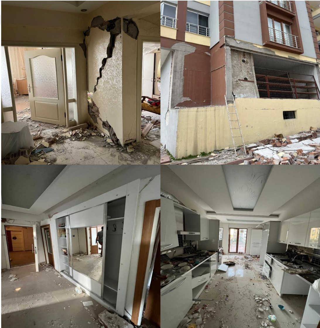
Şekil 4.50. Malatya’da hasar tespit çalışmaları sonucunda gevşek zemin nedeniyle hasar gören bazı yapılar
