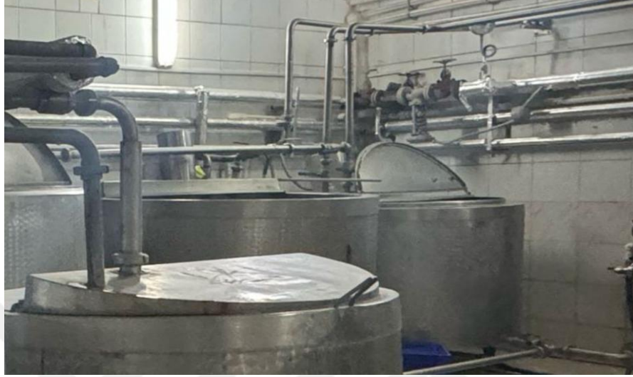
Şekil 4.3. Pastörizasyon tanklarına giden buhar hattına ait görsel
