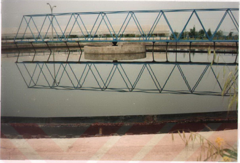
Şekil 3.5: Belediye Arıtım Tesisleri (Atıksu havalandırma havuzu)
