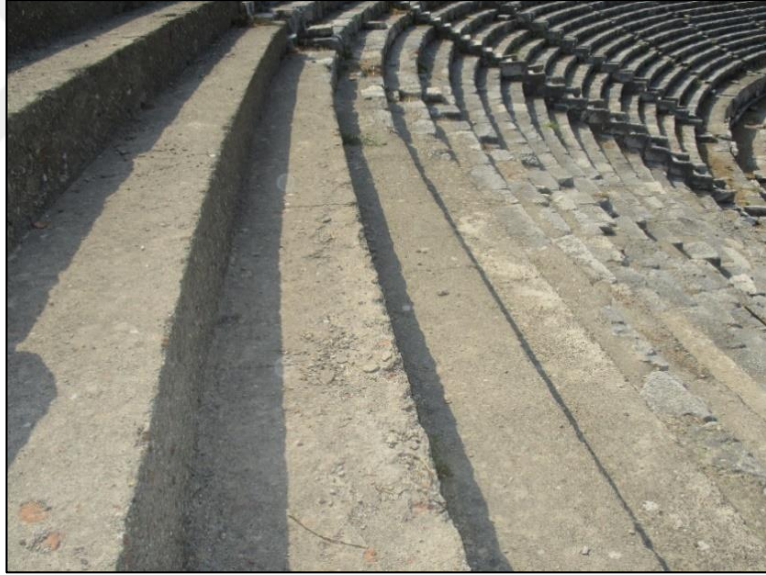
Şekil 5.14 Summa Cavea 70'li yıllarıda yapılan çimento malzemeli tamamlamalar (KVMGM Arşivi, 2021)
