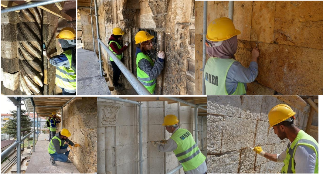
Fotoğraf 4.55. Yonu taşı derz ve temizlik uygulaması (VGM Rapor)
