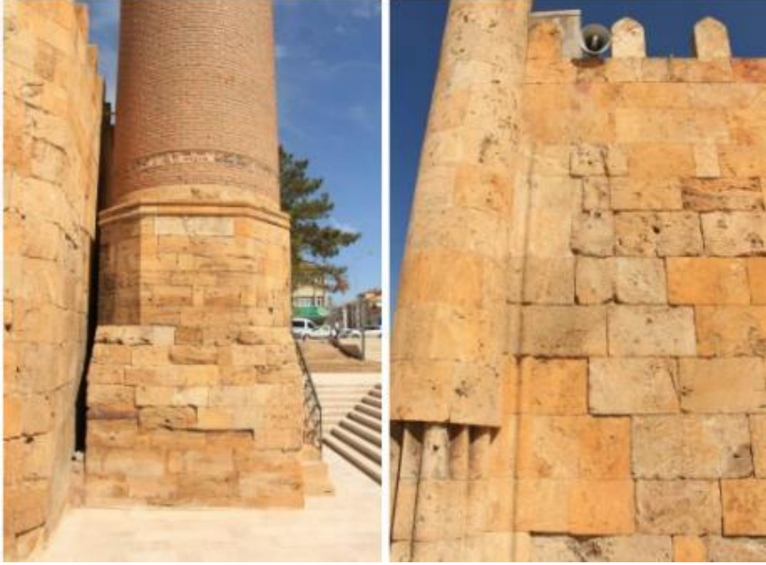
Fotoğraf 3.6. Medrese güney (arka) cephesinde yer alan minarenin taş kaidesi ve Batı cephesinde yapılan onarımlar ve izleri; 1960 restorasyonu sonrası kullanılan yeni taş ile yapının özgün taşları arasındaki renk ve yüzeysel farklar (VGM Rapor)
