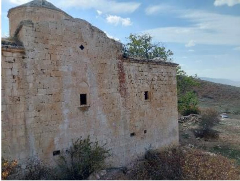
Şekil C. 100:Kilise kuzey cephesinde görülen çiçeklenme ve liken birikimi
