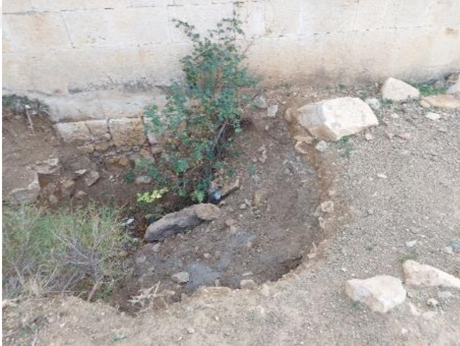
Şekil C. 112:Kilise kuzey beden duvarı dibinde açılan kaçak kazı çukuru
