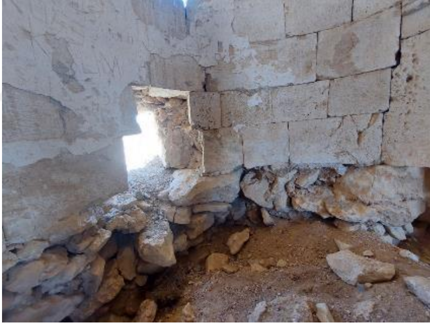
Şekil C. 92:Şapel apsis duvarında tespit edilen bütünlük kaybı
