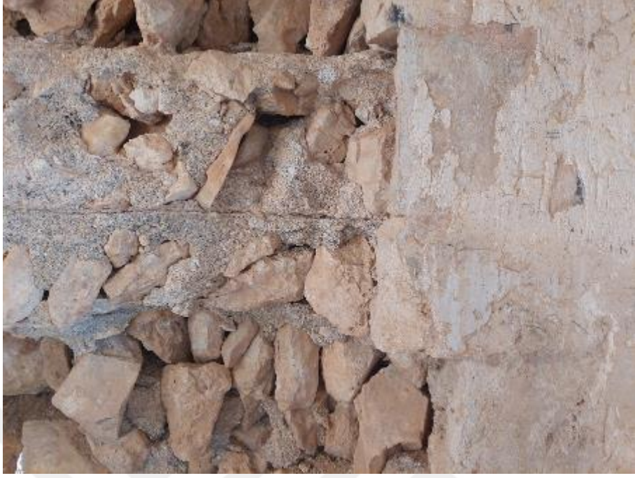
Şekil C. 93:Şapel naos nefinin güney duvarında oluşan cidar kaybı
