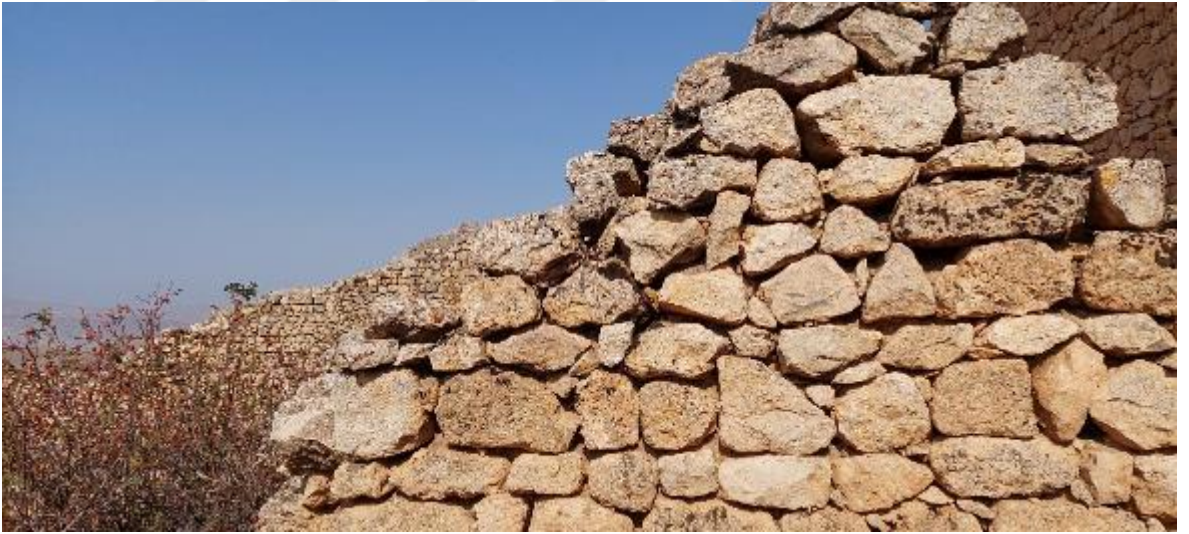
Şekil C. 96:Manastır ek yapıları derz boşalması örneği-1
