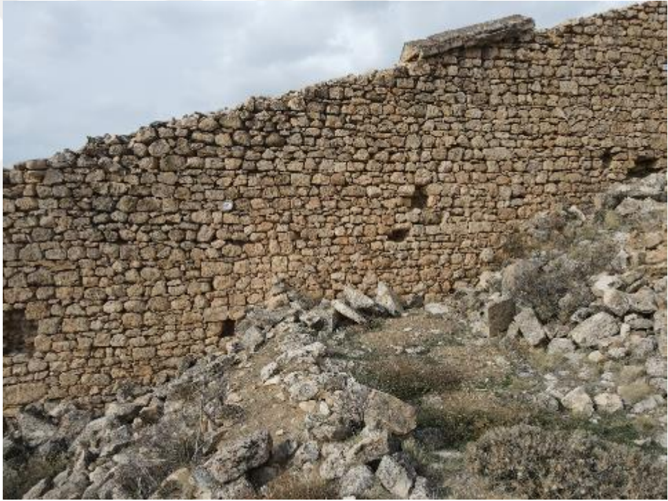
Şekil C.98:Manastır kuzey avlu duvarı iç kısım gözlemlenen derz boşalmaları
