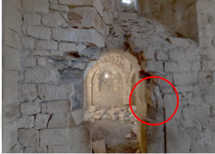
Şekil 3. 2: Güney nef duvarında tespit edilen kemer izi ve söve kalıntıları
