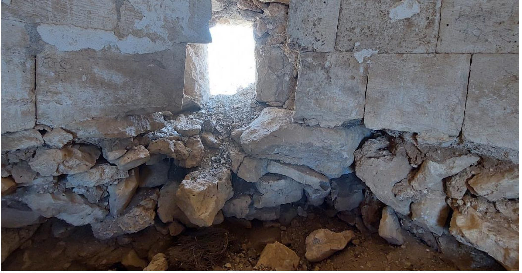
Şekil 4. 1: Müdahale kararı verilen şapel temeli mevcut durum
