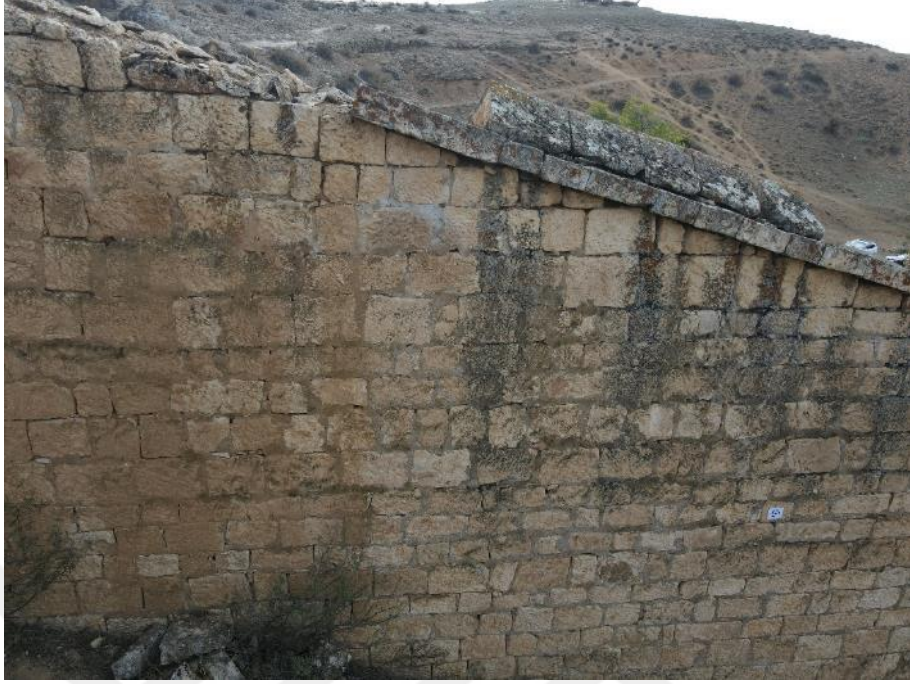
Şekil C.107:Manastır kuzey avlu duvarında oluşan siyah kabuk ve harpuştalar üzerinde tespit edilen likenler
