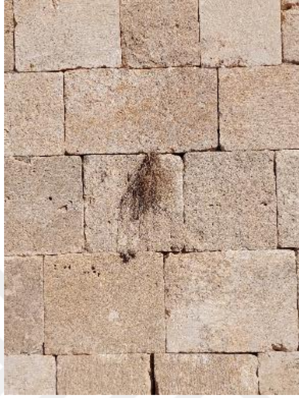
Şekil C. 103: Şapelin güney beden duvar derzlerinde oluşan bitkilenme
