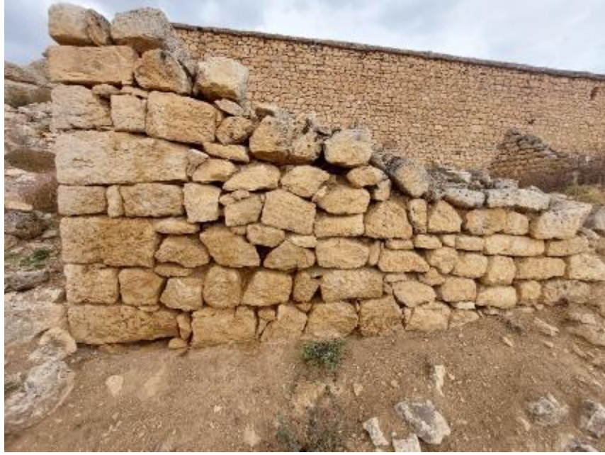
Şekil C. 97:Manastır ek yapıları derz boşalması örneği-2
