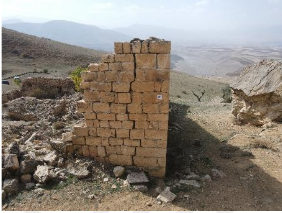
Şekil C. 99:Manastır doğu avlu duvarında yer alan strüktürel çatlak
