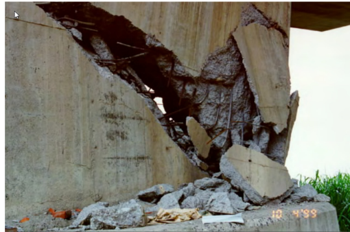
Şekil 1.2 1999 Jiji Depreminde Oluşan Diyagonal Kesme Çatlakları (Sung vd., 2009)
