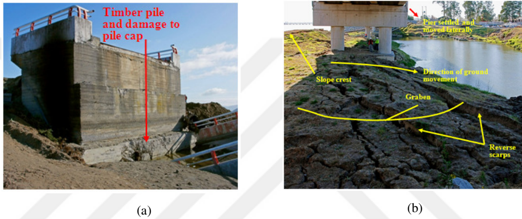
Şekil 1.3 2010 Offshore Maule Depreminde (a) Zemin Deformasyonundan Kaynaklı Üstyapının Düşmesi Sonucu (Yen vd., 2011); (b) Sıvılaşma Kaynaklı Köprü Orta Ayağında Meydana Gelen Asimetrik Oturma (Yen vd., 2011)
