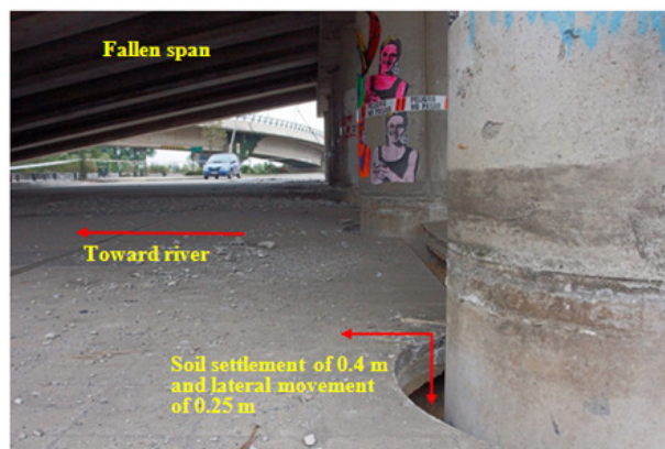
Şekil 1.4 2010 Offshore Maule Depreminde Zemin Deformasyonundan Kaynaklı Üstyapının Düşmesi Sonucu Oluşan Deprem Hasarı (Yen vd., 2011)
