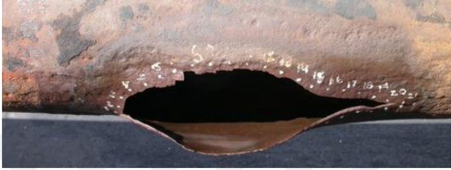
Şekil 3.11. Genel korozyona uğramış boru hattının cidar incilmesi nedeniyle hasarlanması [37]
