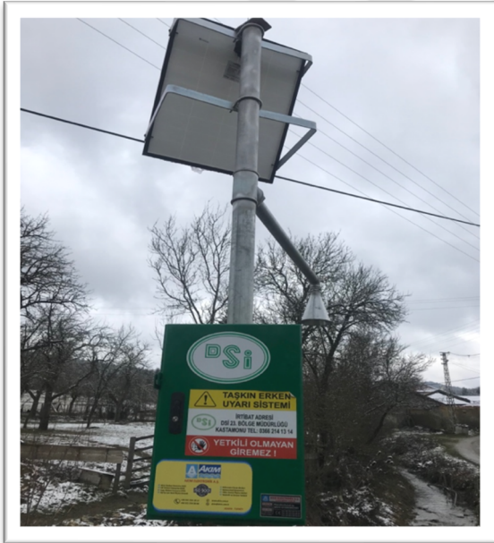
Taşkın Erken Uyarı Sistemi / Emreler Köyü
