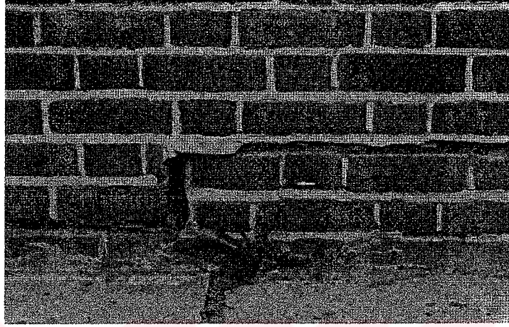
Şekil 4.22 Tuğla duvarda genleşme hasarı [10]
