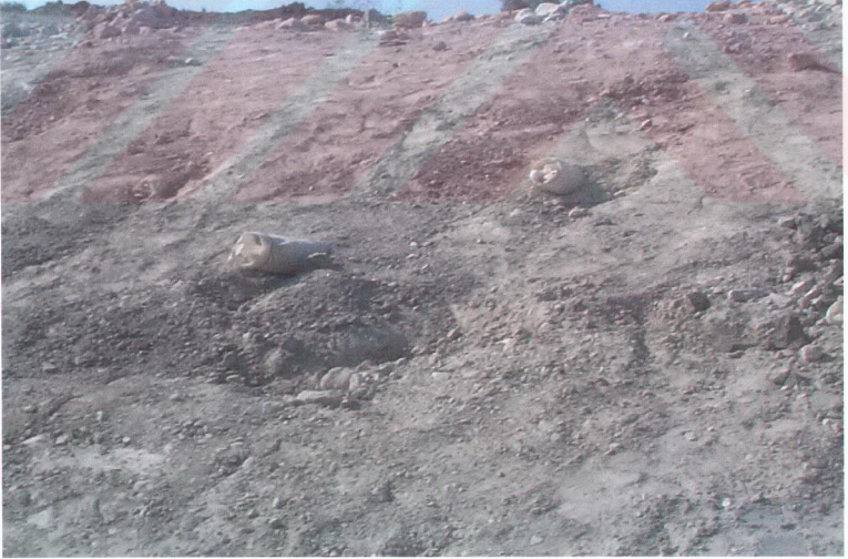
Şekil A2-6. Yatay su drenleri yapılmış jeotekstil sargılı boruların görünüşü.
