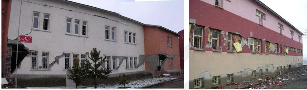
Şekil 2.2 Yığma duvarlarda pencere boşlukları oluşan kesme çatlakları (2004 Erzurum depremi)
