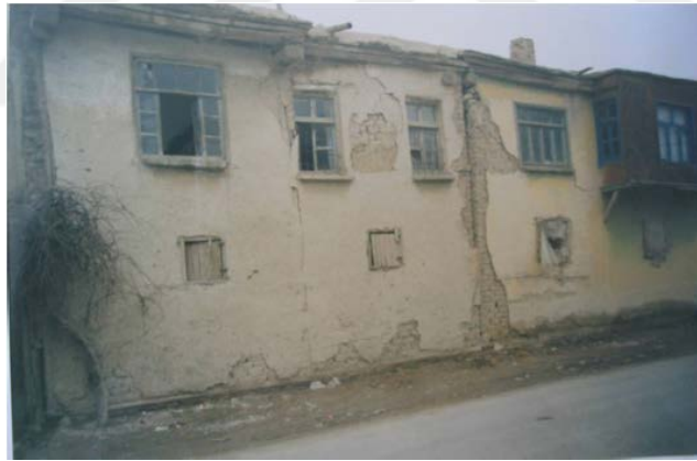
Sekil 2.7 Yığma yapıda çarpma hasarı (S. Korkmaz arşivi)
