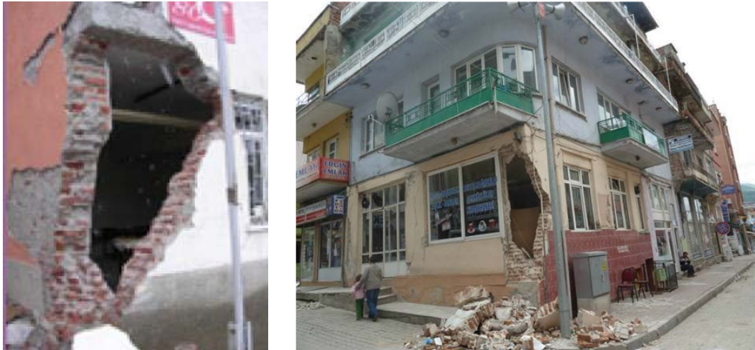
Şekil 2.3 Yığma duvarlar birleşimlerinde köşe hasarları a) 2004 Erzurum depremi b) 2011 Kütahya Simav depremi
