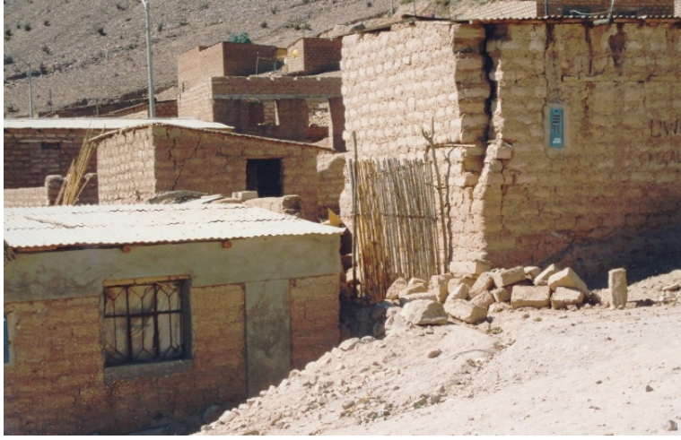
Şekil 2.24 2001 Depremi sonrası Moquegua'da hasarsız güçlendirilmiş konut ve takviyesiz ağır hasarlı komşu konut (Quiun, 2008) (EERI ve IAEE)
