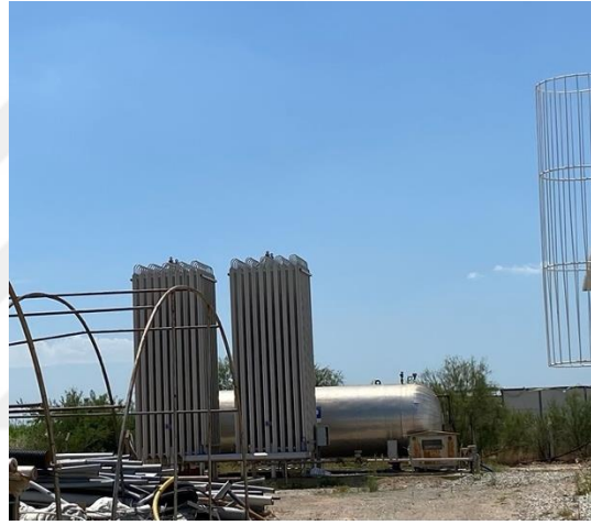
Fotoğraf 16. Kriyojenik Karbondioksit tankı
