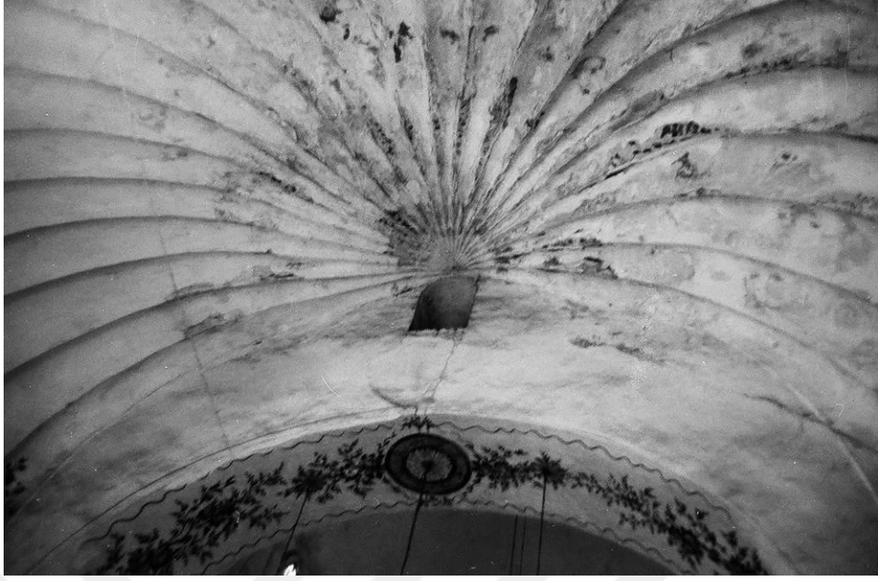
Fotoğraf 144. Restorasyon Öncesi Kubbe Dilimindeki Boya Kalıntıları (Vakıflar Genel Müdürlüğü Arşivi, 2023)
