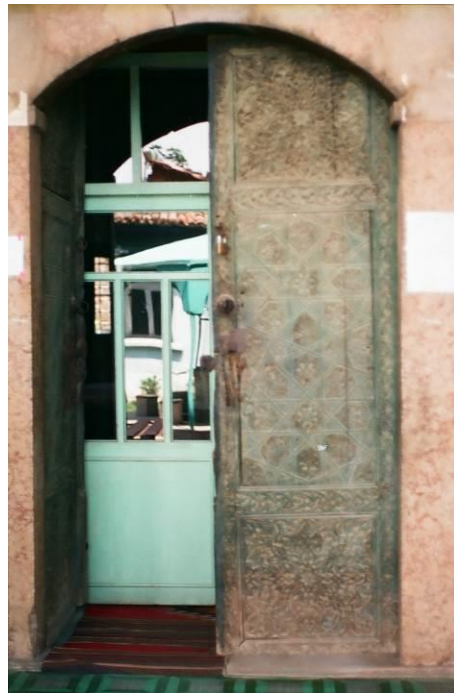
Fotoğraf 59. Orijinal Cümle Kapısı ve İç Kapının Eski Durumu
