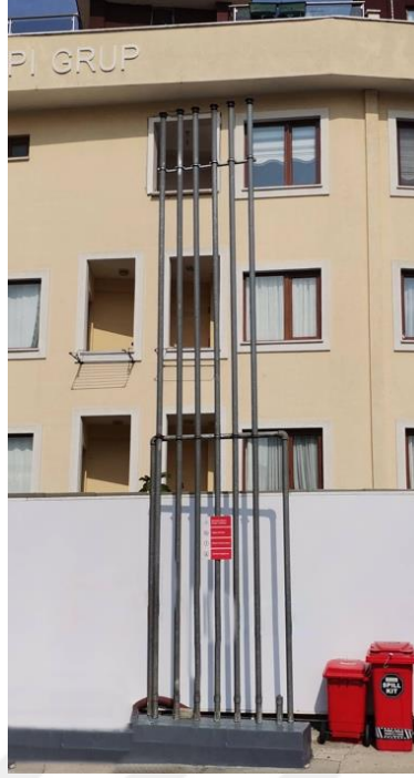
Şekil 7.1 : Örnek : akaryakıt istasyonu nefeslik ve yakınındaki konutlar.
