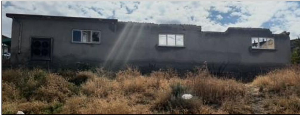
Şekil 4.42. Yıkıntı durumundaki düğün salonu (Kişisel arşiv, 2023)
