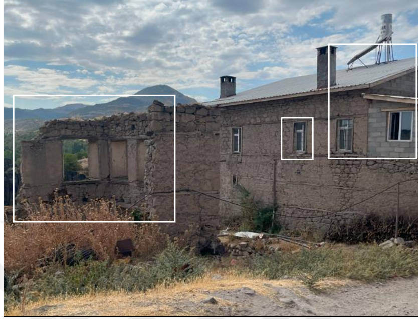
Şekil 4.89. Harabe yapı örneği ile yanlış müdahalelere maruz kalmış yapı örneği (Kişisel arşiv, 2023)
