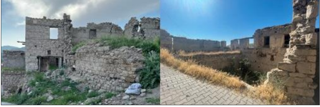
Şekil 4.41. Yıkıntı durumundaki geleneksel yapı örneği (Kişisel arşiv, 2023)
