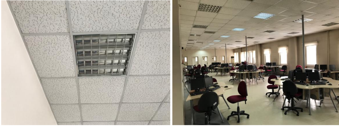
Şekil 31: Yapıda Kullanılan Armatür Örneği ve Bilgisayar Laboratuvarı Aydınlatması
